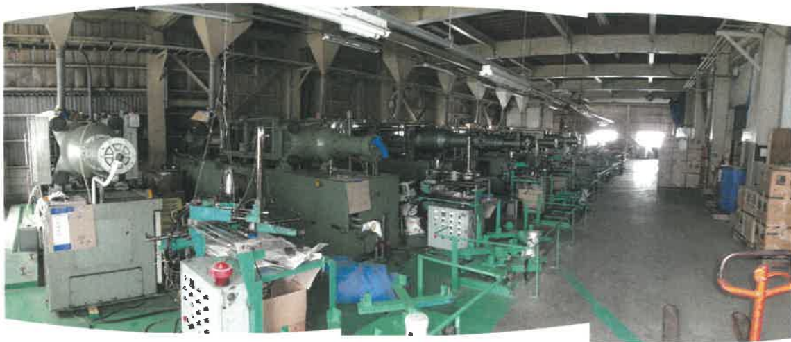
物件 1 4 建物の 1 階西側ゾーンの工場内の機械器具類の状況 (「工場抵当法第 2 条に該当する機械器具類等目録」記載の番号 1 ～ 8)
