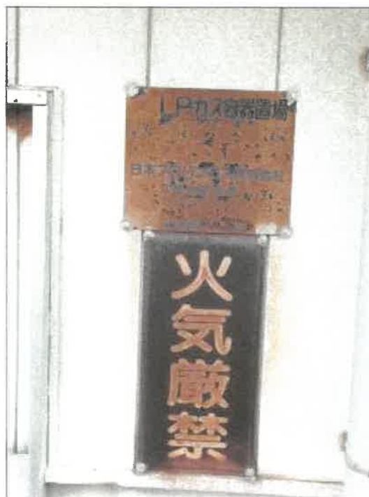
物件 1 4 建物の南西側の P L ガス容器置場の看板の状況
