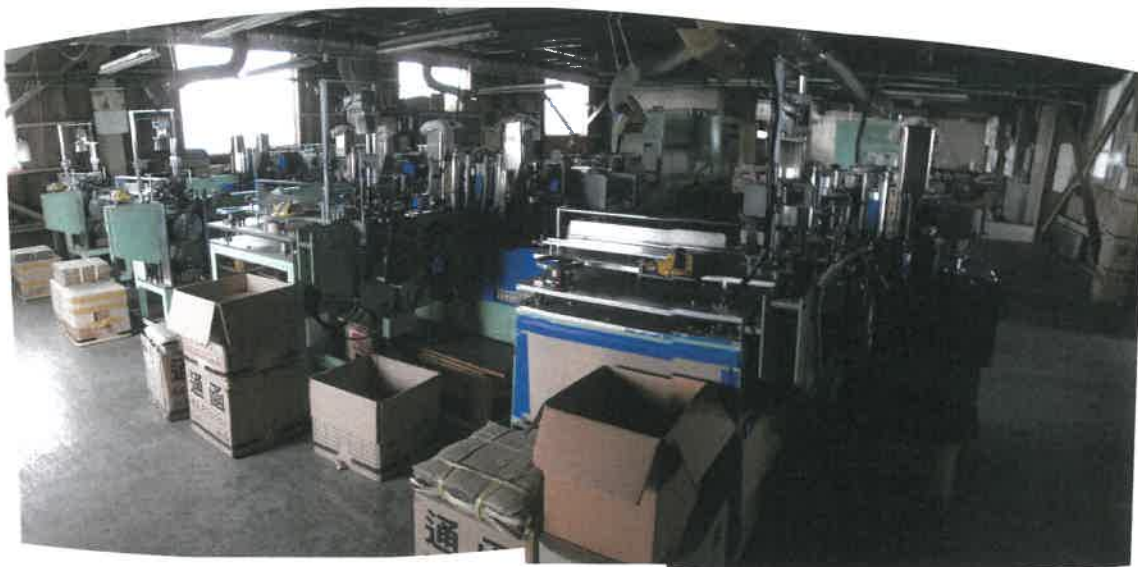
物件14建物の2階東側ゾーン南側工場内の機械器類の状況 (「工場抵当法第2条に該当する機械器具類等目録」記載の番号11～14)
