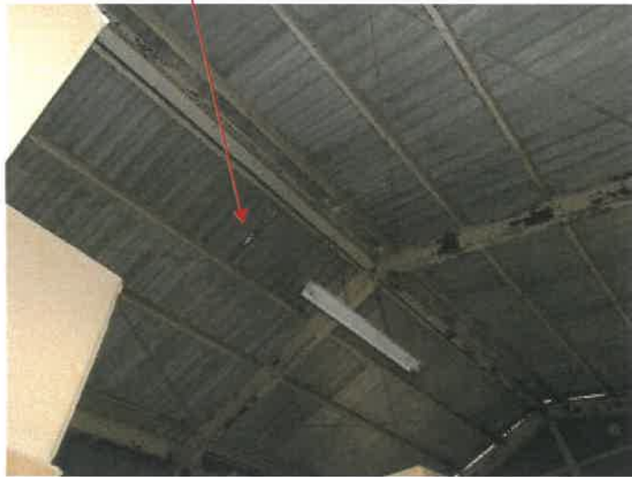
物件16建物の屋根の損傷の状況
