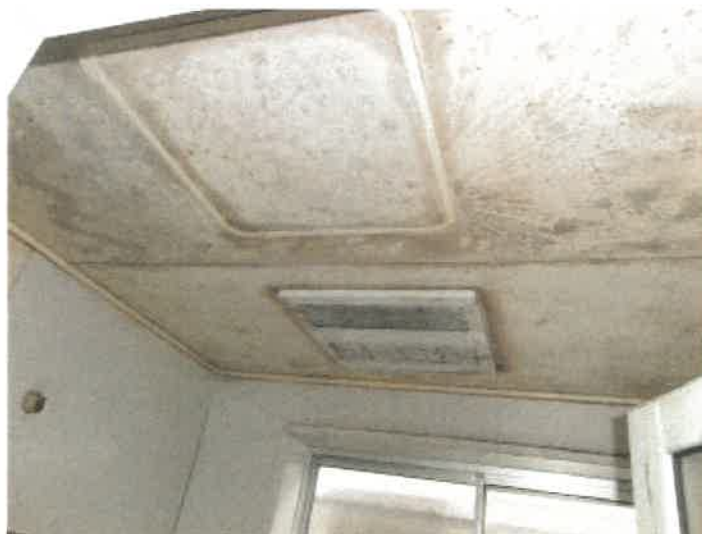
物件 2 建物の 1 階浴室天井の状況
