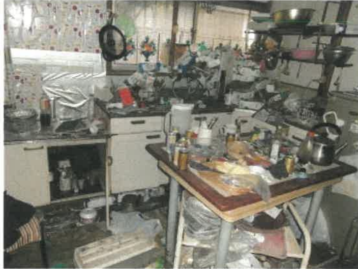
物件2建物の1階DKの状況
