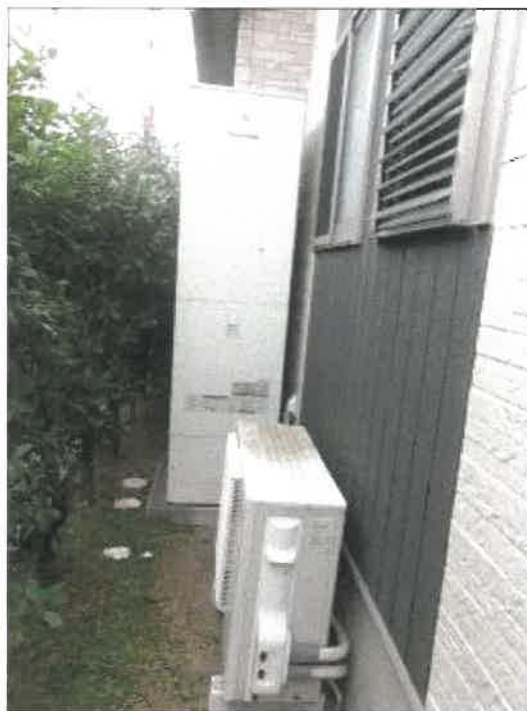
物件 2 建物の北側のエコキュートの設置状況
