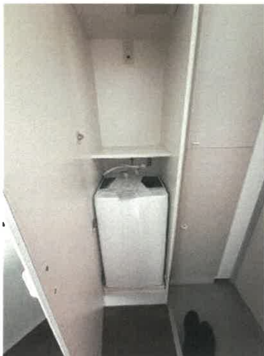
洗濯機置場の状況
