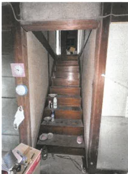
物件3 階段の状況
