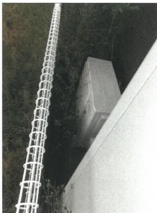
物件 2 建物の西側のエコキュート設置状況
