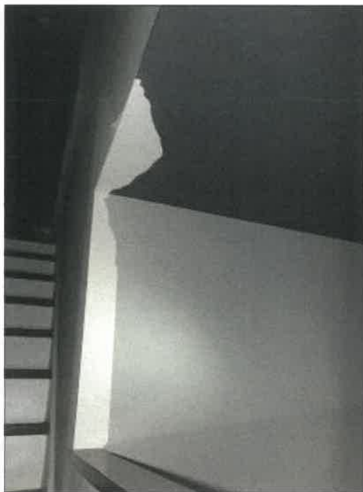
物件 2 建物の 1 階階段付近壁の壁紙の損傷状況
