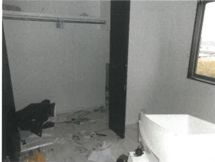
物件2建物の2階北側西洋室の状況
