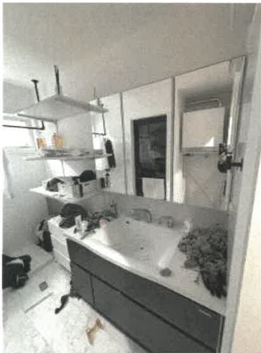
物件4 1階洗面所の状況
