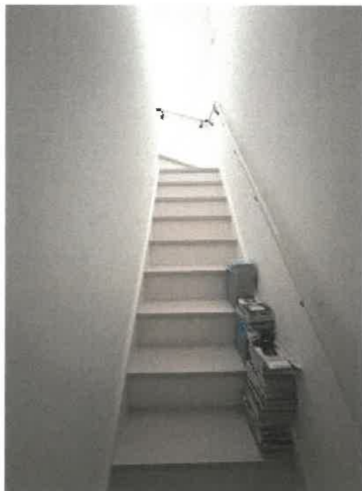
物件 4 階段の状況
