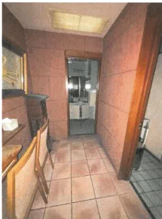
物件3 ユーティリティの状況
