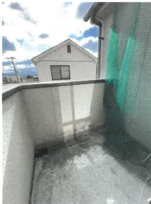
物件2 3階バルコニーの状況
