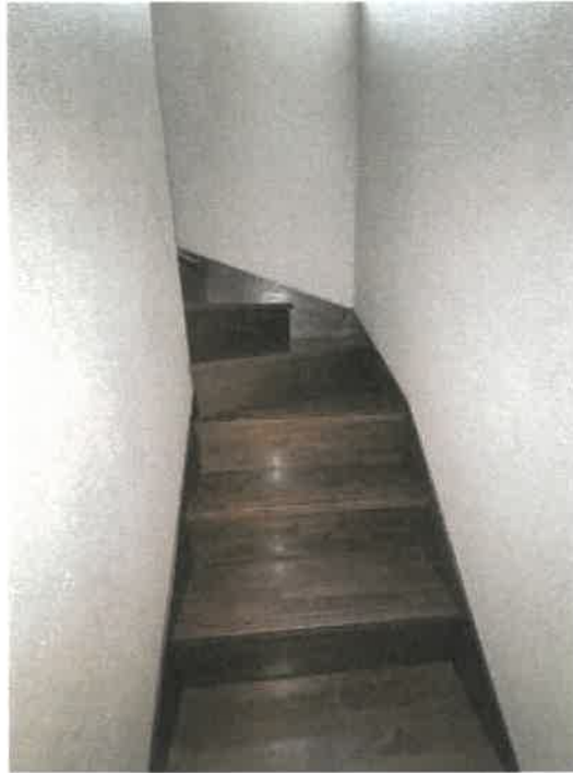
物件2 階段（2～3）の状況
