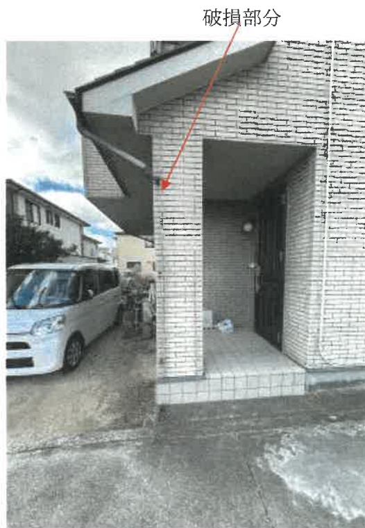
物件2 雨どい破損状況
