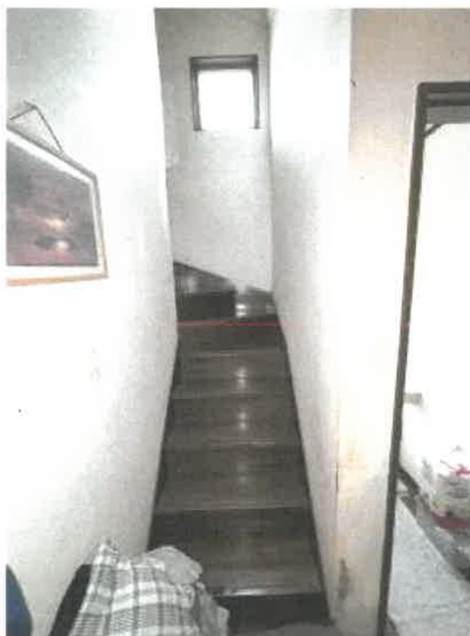
物件2 階段（1～2）の状況
