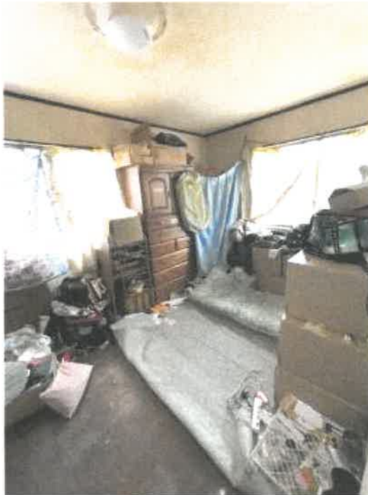
物件2 3階北側洋室の状況
