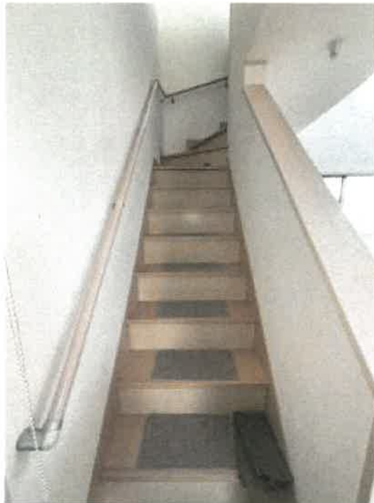
物件2 階段の状況
