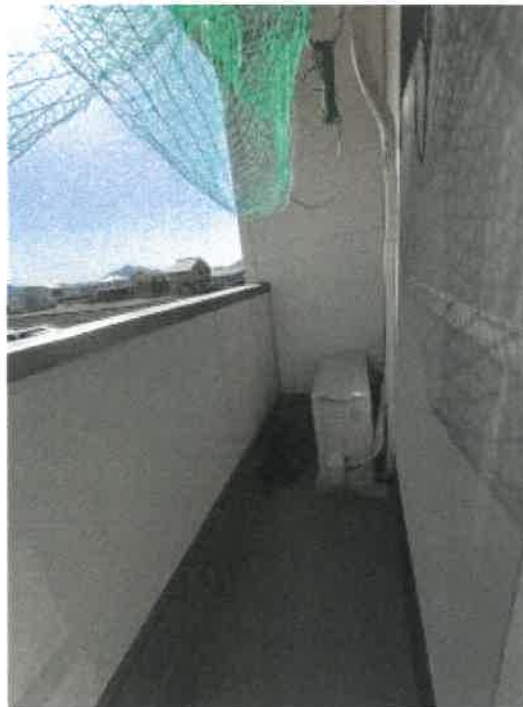
物件2 2階ベランダの状況
