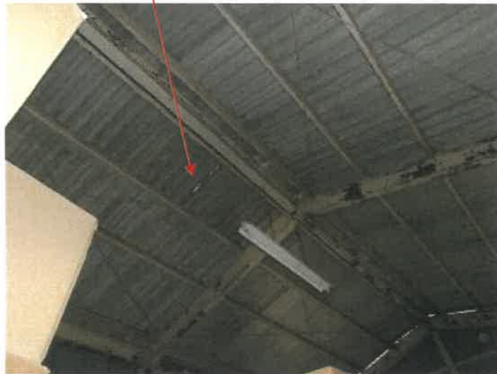
物件16建物の屋根の損傷の状況
