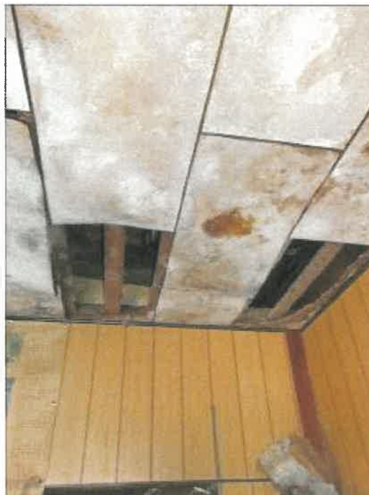
物件 1 5 建物の 1 階東側倉庫の天井の雨漏りによる損傷の状況
