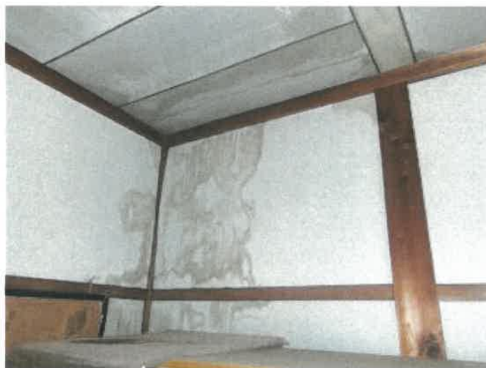
物件15建物の2階東側和室の雨漏りの状況
