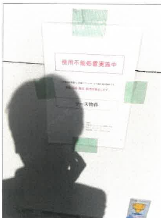
エコキュートの「使用不能処理実施中」の連絡票貼付状況
