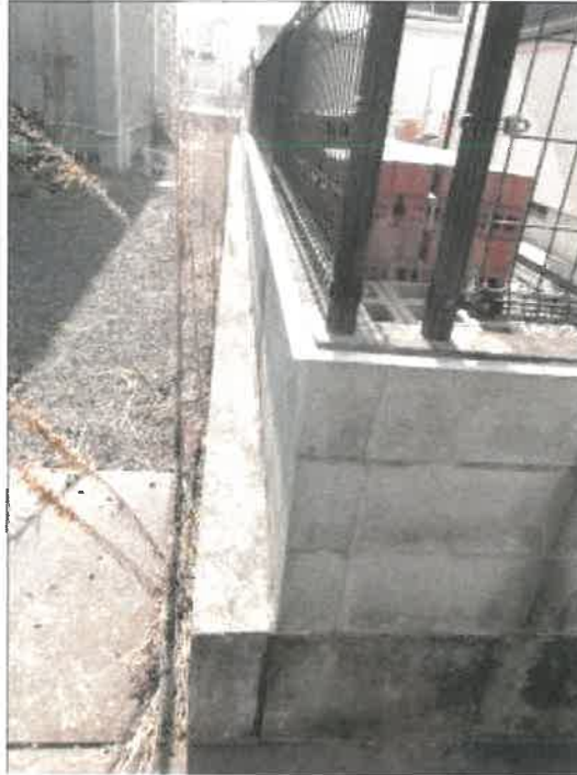
物件 1 土地南西側隣地の北東側ブロック塀の水切金の設置状況
