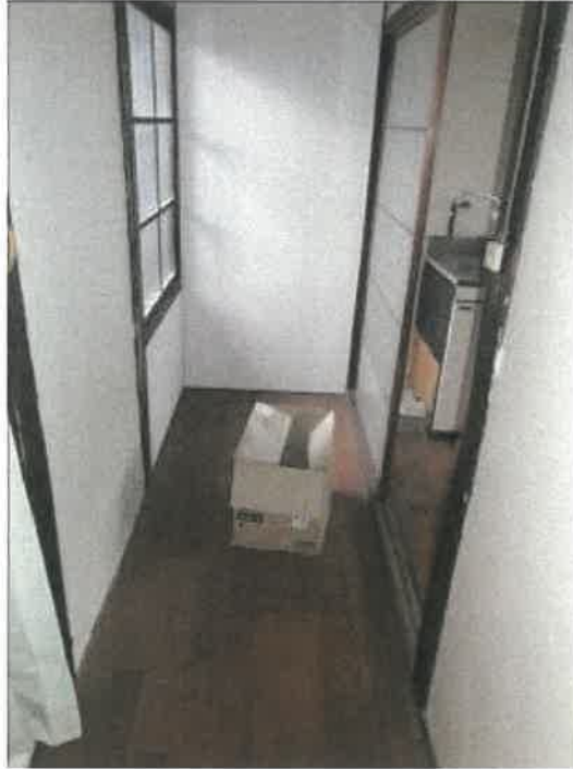
物件5主である建物のDK西側廊下付近の状況
