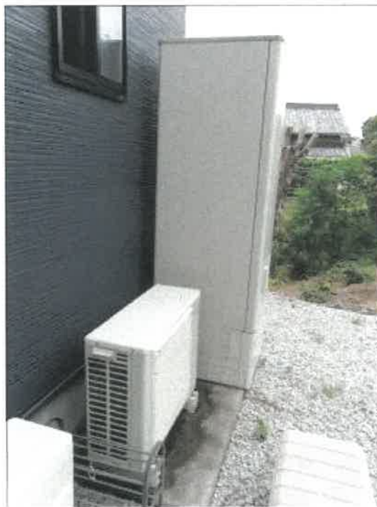
物件6建物東側のエコキュート設置状況
