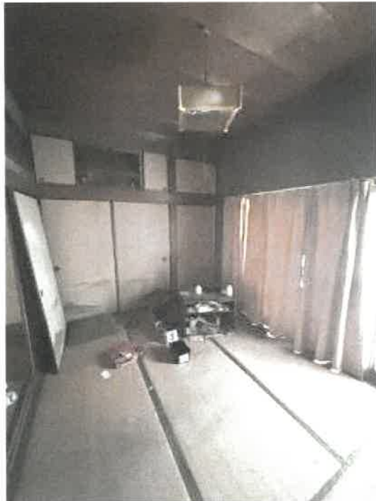
物件3 1階北西側和室の状況
