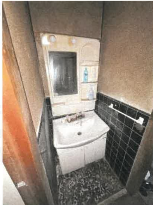
物件3 1階洗面台付近の状況
