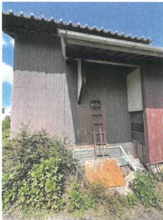
物件3 未登記増築部分（物置）の状況
