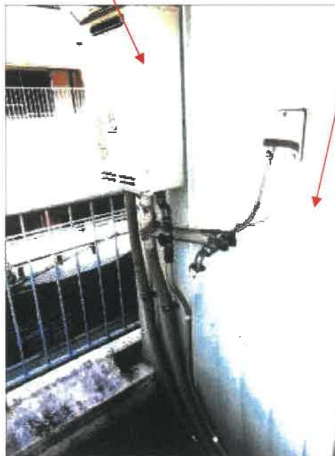
物件4建物の4階401号室のバルコニーの状況
