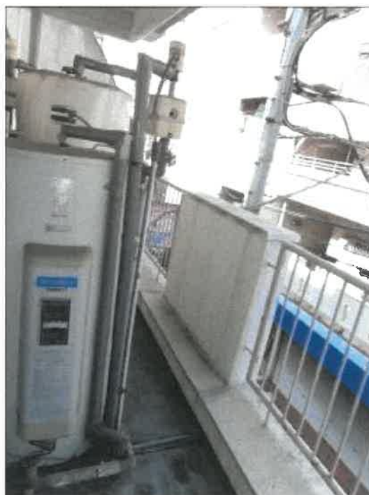
物件4建物の3階301号室のバルコニーの状況
