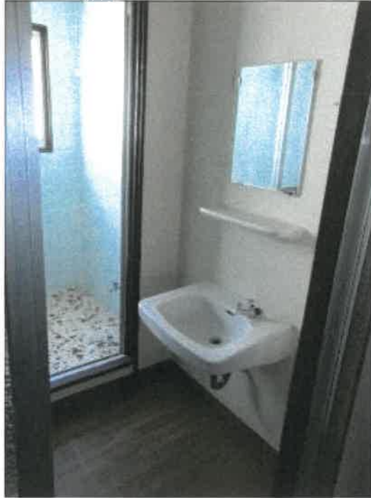
物件4建物の5階501号室の洗面脱衣所の状況
