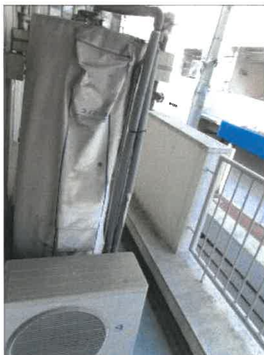
物件4建物の2階201号室のバルコニーの状況
