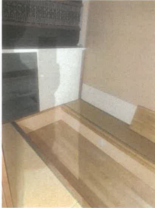
物件4建物の1階店舗部分の南端西の食事処の状況
