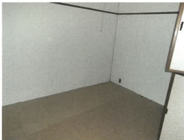
物件4建物の4階402号室の北側和室の状況
