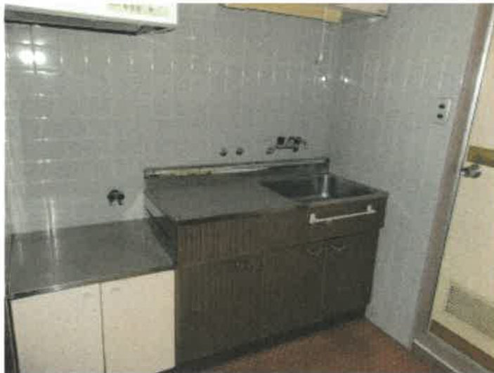
物件4建物の3階302号室のキッチン付近の状況
