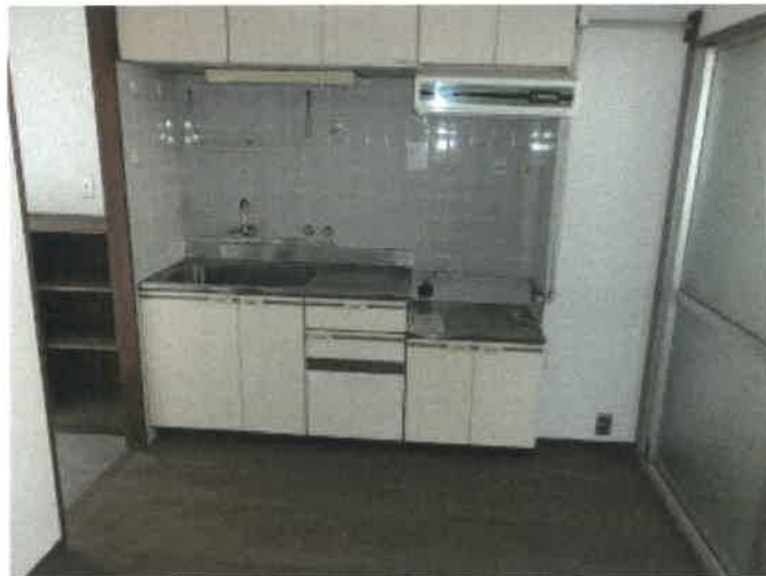
物件4建物の5階501号室のDKの状況
