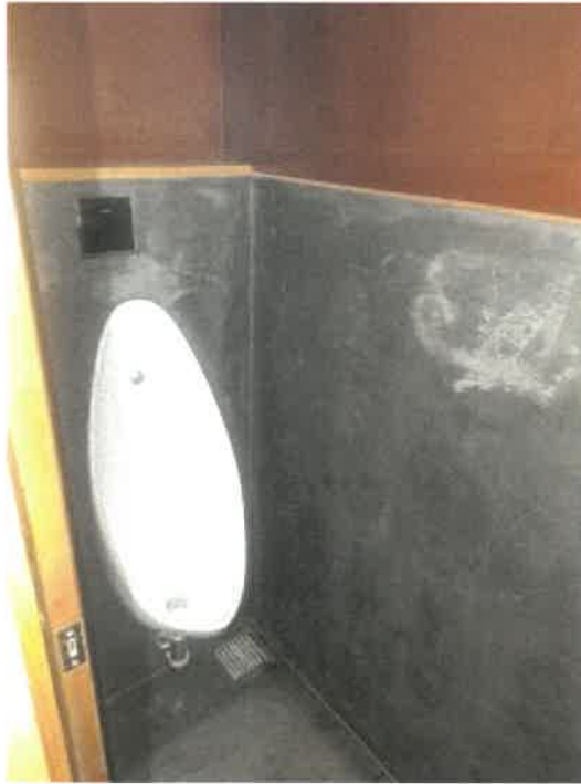
物件4建物の1階店舗部分のトイレの状況
