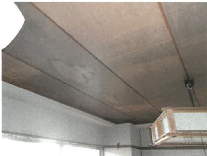
物件4建物の3階201号室の東側和室天井の雨漏り痕の状況
