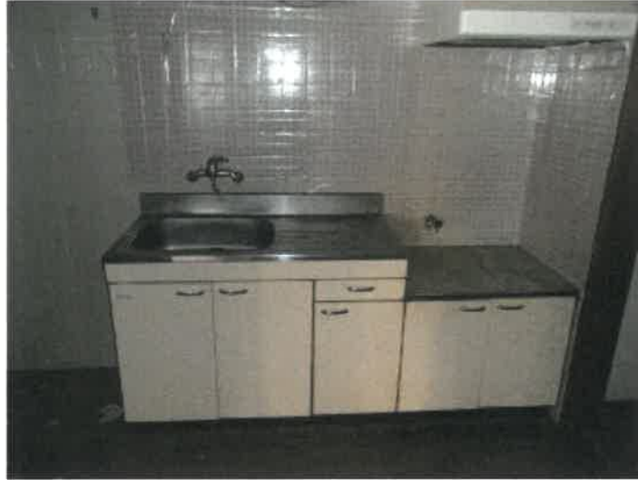
物件4建物の3階201号室のDKの状況
