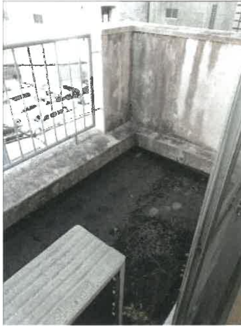
物件4建物の4階401号室のバルコニーの状況 ガス給湯器
