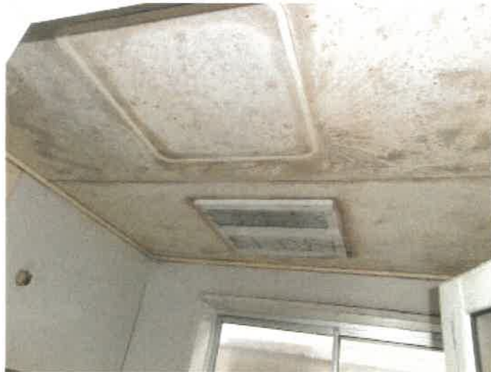
物件 2 建物の 1 階浴室天井の状況
