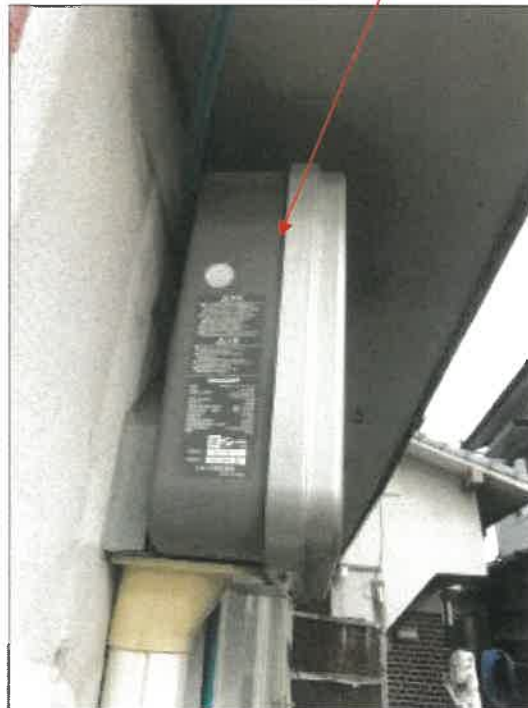
太陽光発電パワーコンディショナー設置の状況
