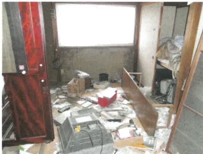
物件2建物の2階東端和室の状況
