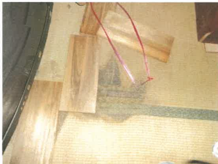
物件 2 建物の 1 階玄関東側和室の畳の損傷状況
