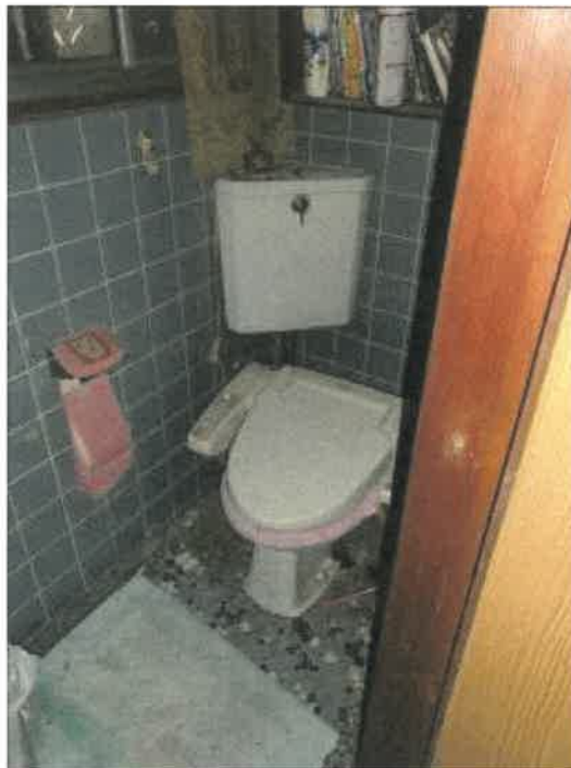
物件 2 建物の 1 階浴室南側のトイレの状況
