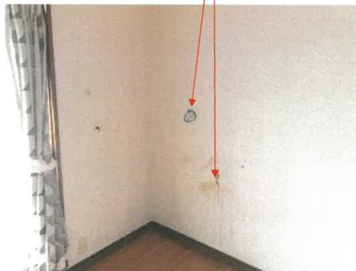
物件 2 建物の 2 階西側洋室の壁の損傷個所の状況
