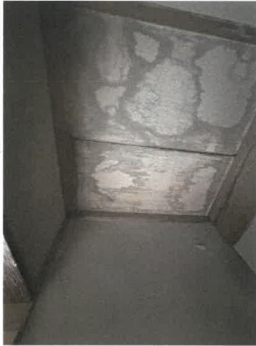
物件2 1階南西側和室床の間の天井の状況
