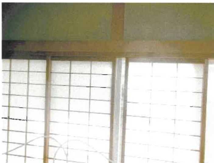
物件4建物の1階西側和室2間の鴨居中央付近が下がっている状況
