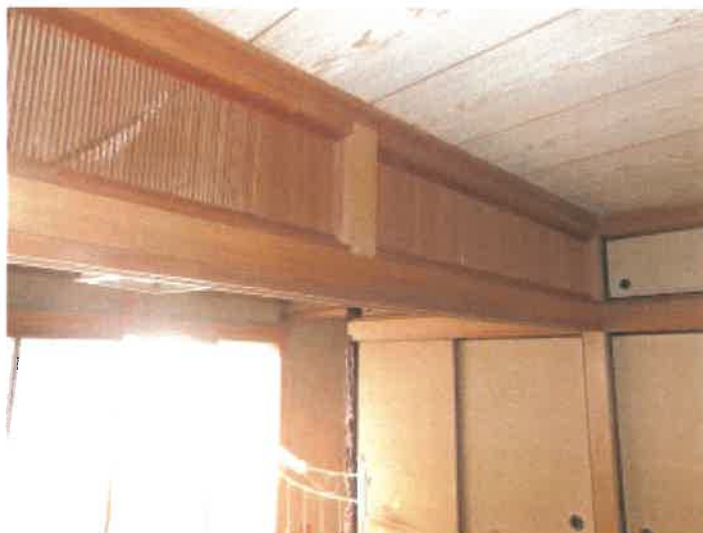
物件4建物の1階西側和室2間の鴨居の中央付近が下がっている状況
