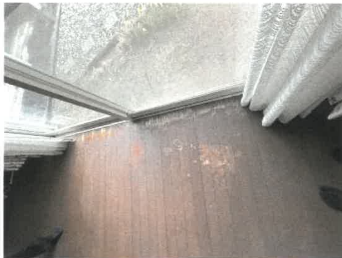
物件2 1階リビング床の状況
