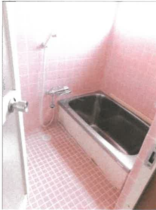
物件2建物の1階浴室の損傷状況
