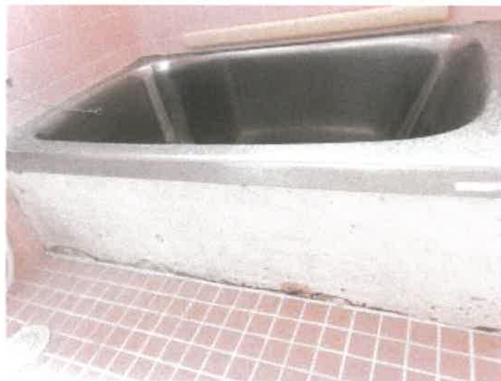
物件2建物の1階浴室の損傷状況
