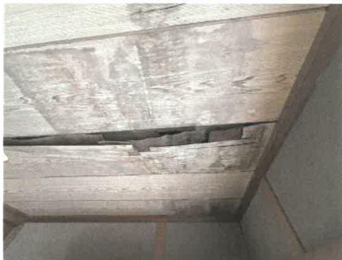
物件2 1階南西側和室天井の破損状況
