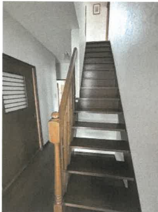
物件2 階段の状況
