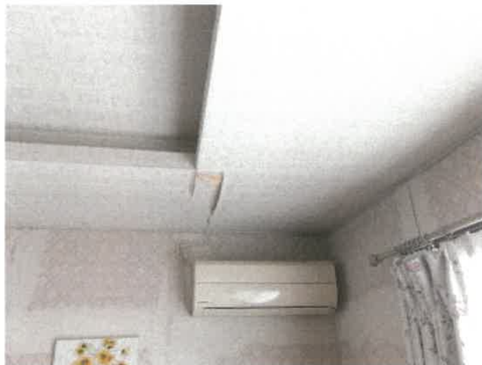
物件 2 建物の 1 階 L D K の天井南東角付近の壁紙の損傷状況
