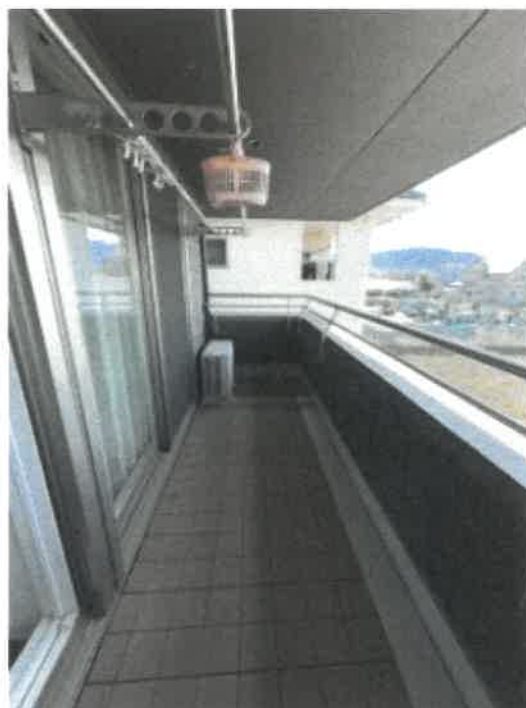
物件2 バルコニーの状況
