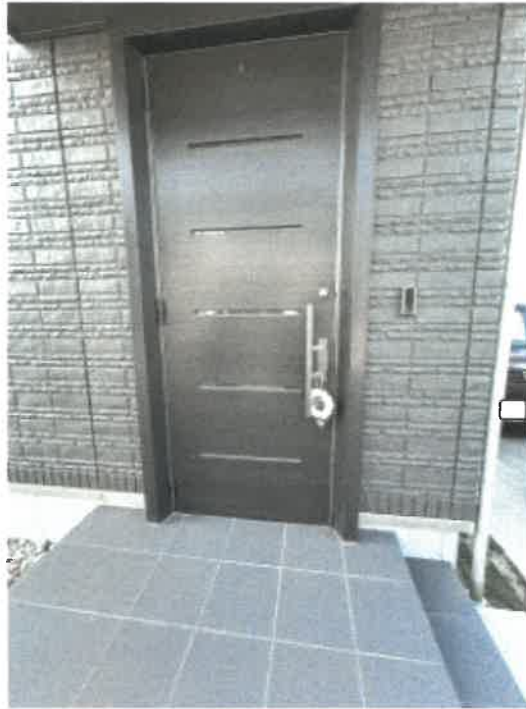
物件2 玄関ドアの状況
