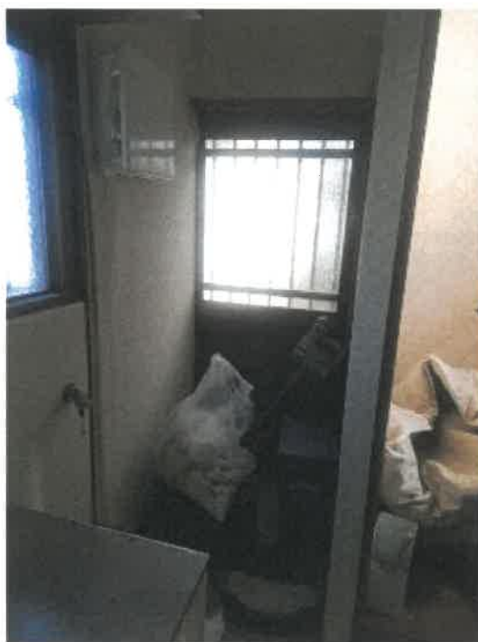
物件2主である建物の北ゾーンの1階東側洋室（DK）の勝手口付近の状況
