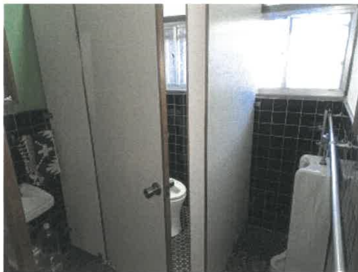
物件2主である建物の1階南ゾーンのトイレの状況
