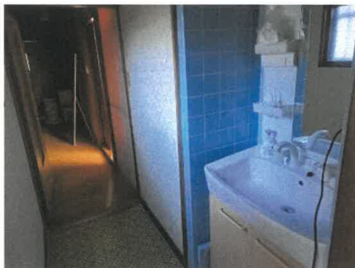
物件2主である建物の1階南ゾーンから北ゾーンへの廊下の状況
