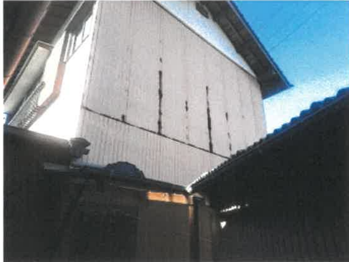
物件 2 主である建物北ゾーンの東側外壁の劣化の状況
