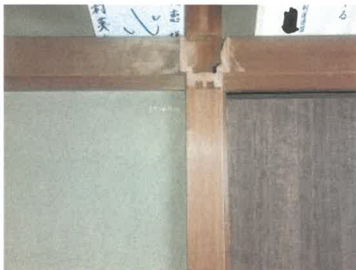
物件2主である建物の1階南ゾーン西端洋室の状況2間の間の鴨居を撤去している状況
