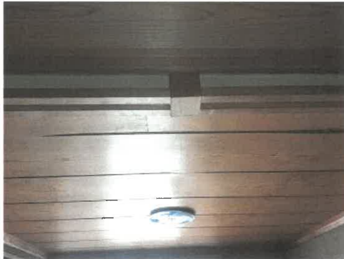
物件2主である建物の1階南ゾーン西端洋室の状況2間の間の鴨居を撤去している状況
