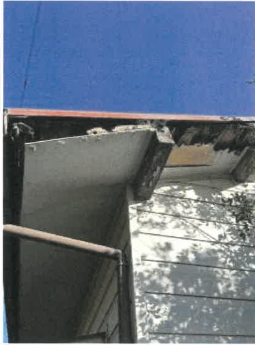
物件2 軒先付近の状況
