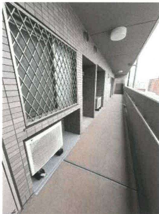
本件物件前廊下の状況
