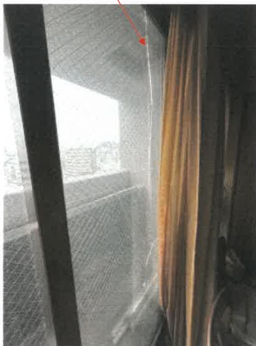
本件物件居間食堂のガラスのひび割れ状況
