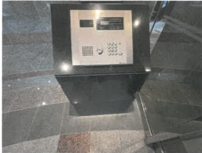
本件マンションの集合インターホンの状況
