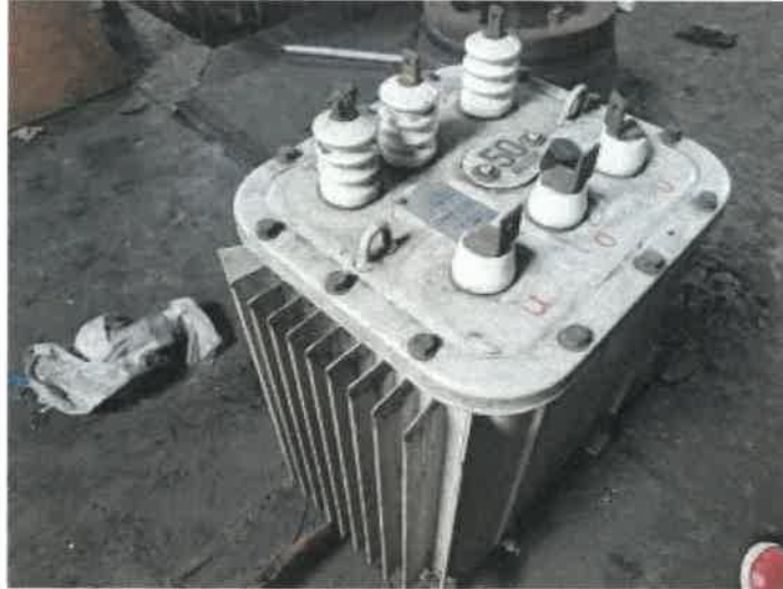
物件2主である建物（工場）内の南端の自動再生タイヤ加硫機付近の放置されたトランスの状況
