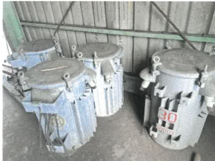
高圧変電設備内の取り外されたトランスの状況
