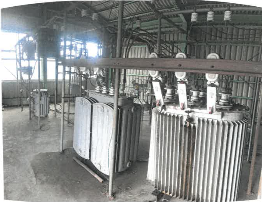
高圧変電設備内の状況
