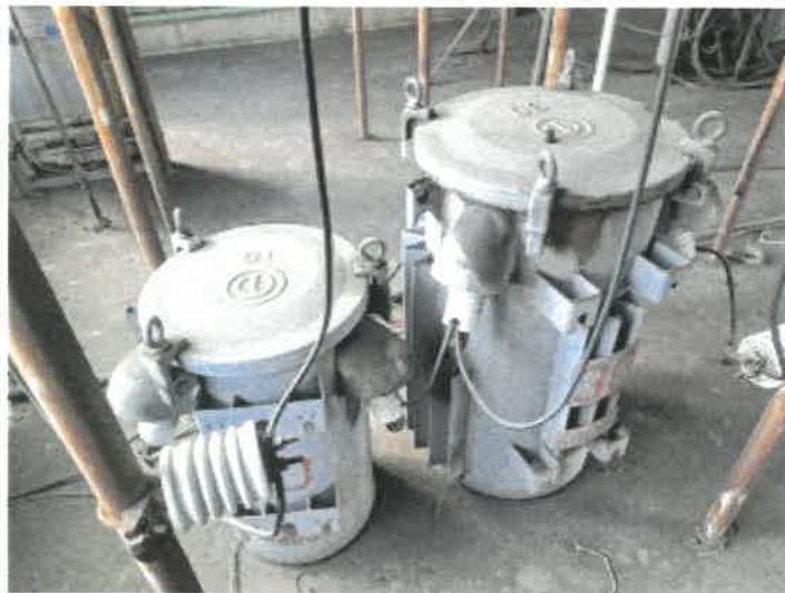
高圧変電設備内の状況
