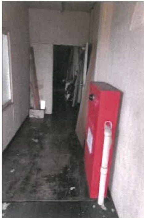
物件 2 主である建物南側事務所部分の 2 階出入口付近の状況
