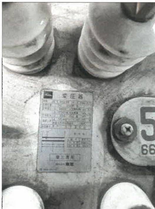
物件2主である建物（工場）内の南端の自動再生タイヤ加硫機付近の放置されたトランスの状況
