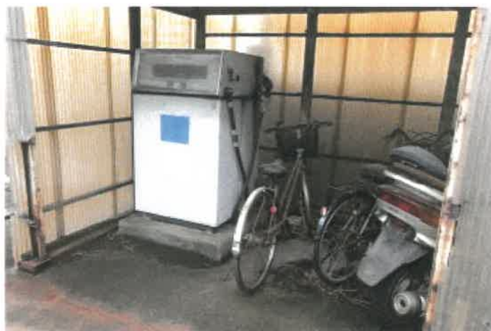
物件2主である建物工場部分南側の西外側の軽油給油機の状況
