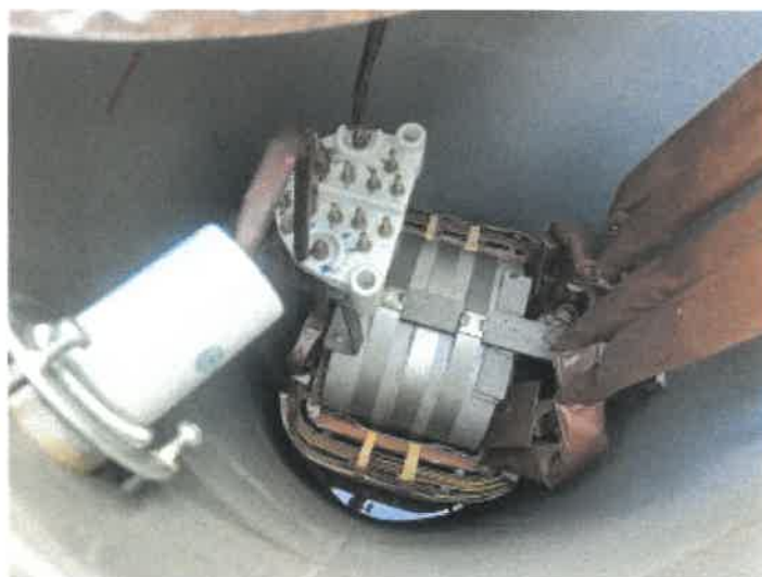
物件 2 主である建物の西側の南側下屋の北側付近の放置されたトランス内の状況
