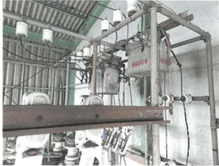
高圧変電設備内の状況
