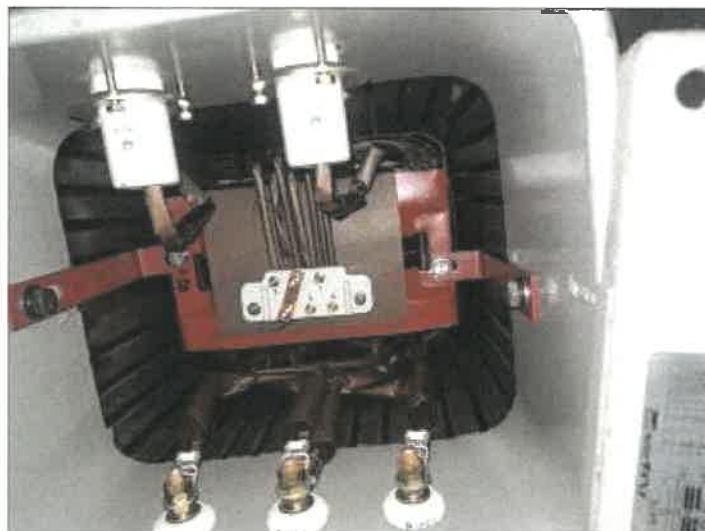
物件2主である建物（工場）内南端付近の放置されたトランス内の状況
