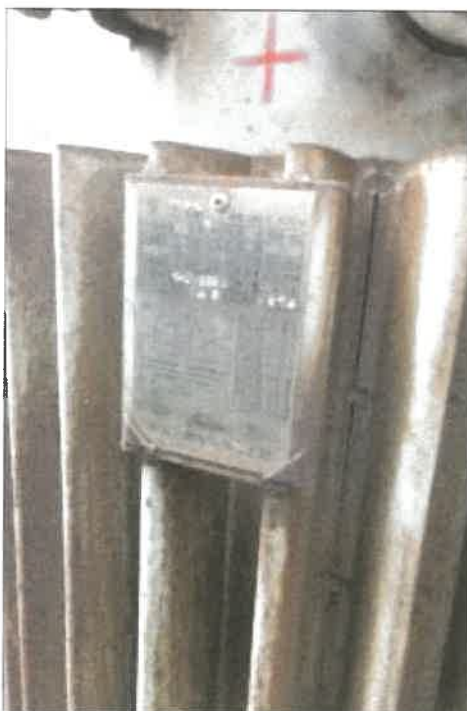
物件 2 主である建物の西側の南側下屋の北側付近の放置されたトランスの状況
