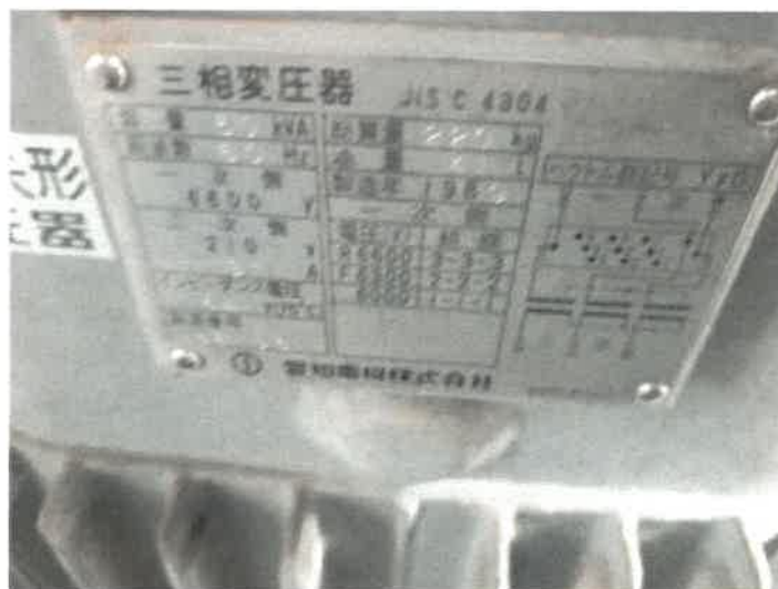
物件2主である建物（工場）内南端付近の放置されたトランスの状況
