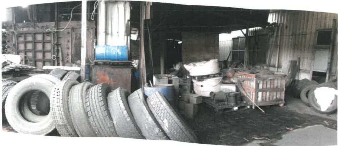
物件2主である工場部分北側の東側下屋内に存在する廃タイヤボイラ兼焼却炉の状況
