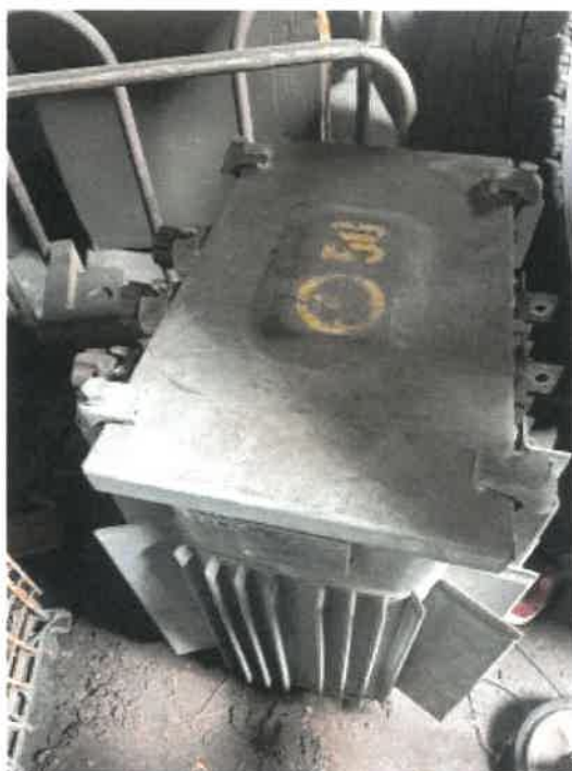
物件 2 主である建物（工場）内南端付近の放置されたトランスの状況
