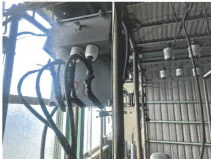
高圧変電設備内の状況
