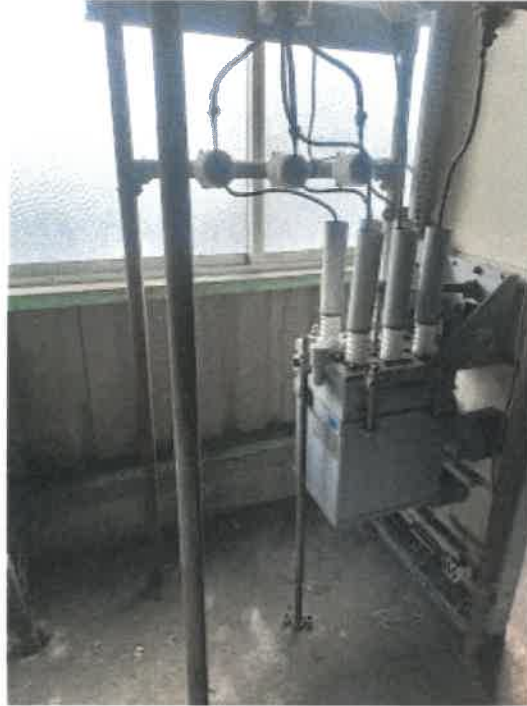
高圧変電設備内の状況
