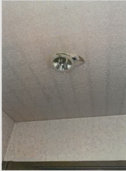
物件3 3階北西側洋室天井ライトの損傷状況
