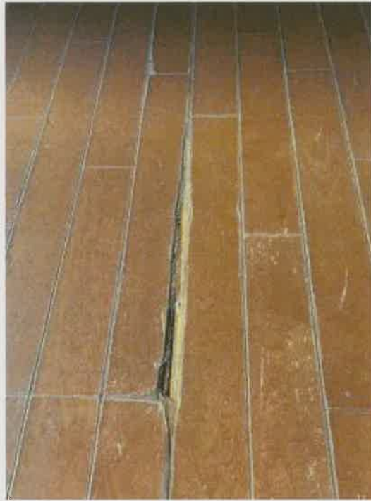
物件3 2階LD床の損傷状況
