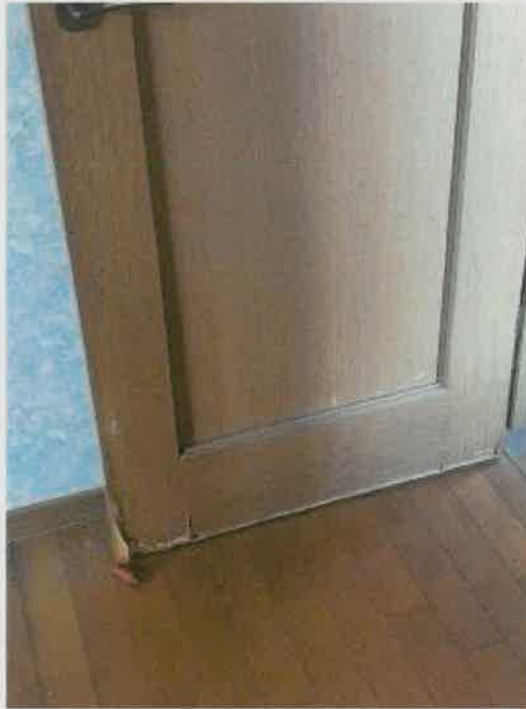
物件3 1階南側洋ドアの損傷状況
