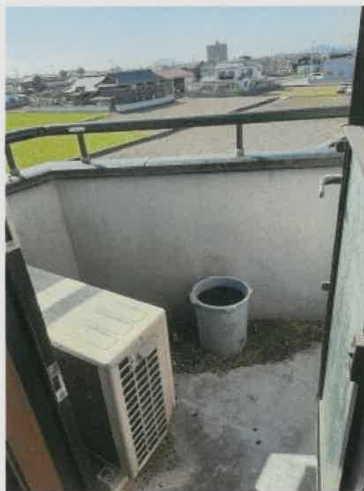
物件3 3階北西側バルコニーの状況
