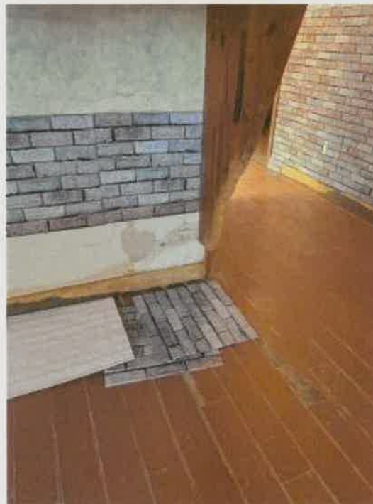
物件3 2階LDの壁等の損傷状況
