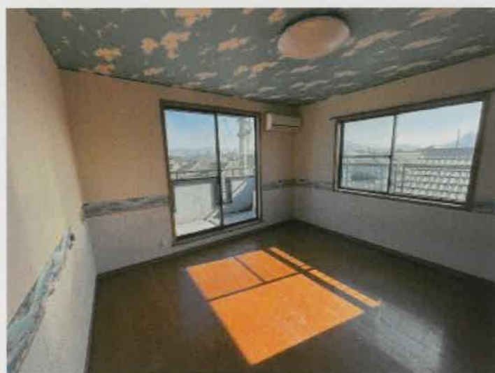
物件3 3階南側洋室の状況
