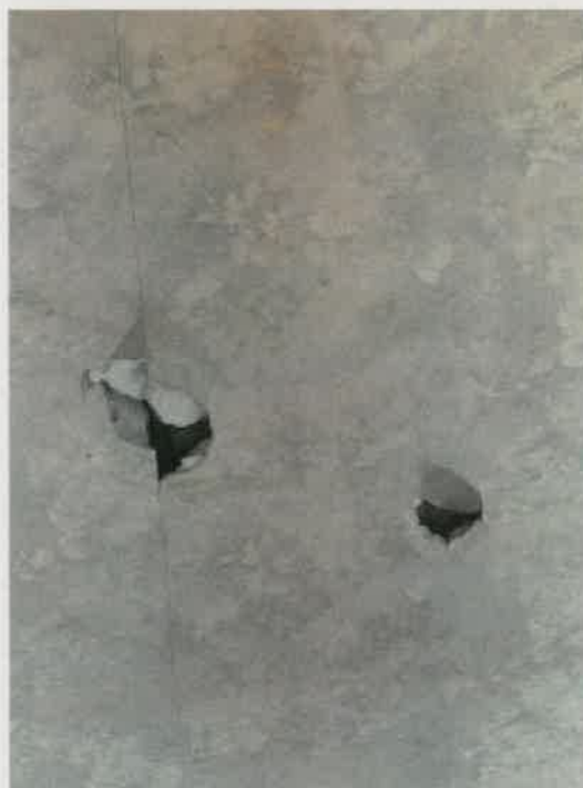
物件3 1階南側洋室壁の損傷状況
