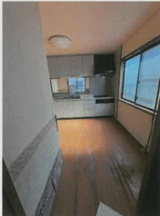
物件3 2階台所床の損傷状況
