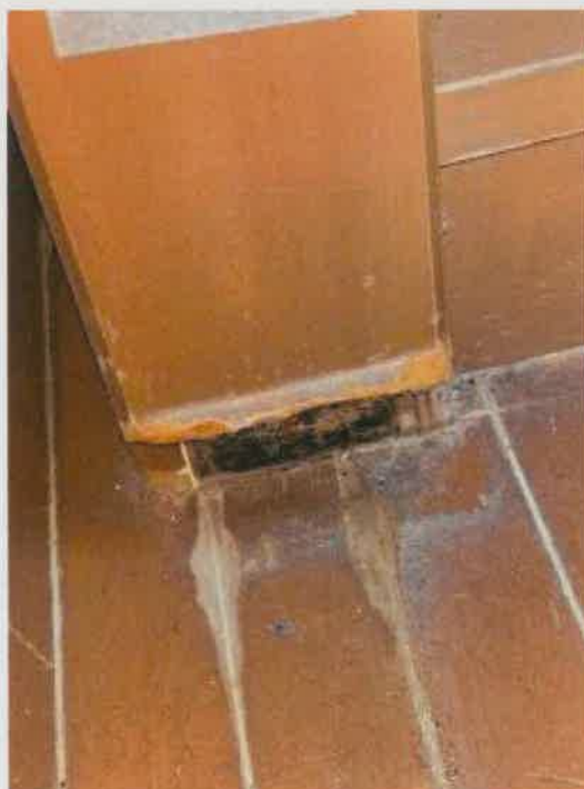
物件3 1階階段下の損傷状況
