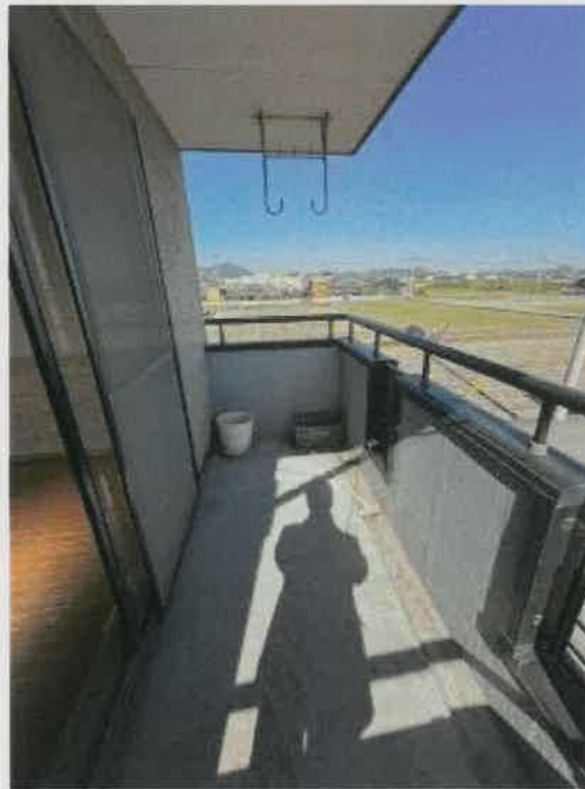
物件3 2階バルコニーの状況
