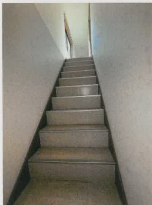
物件4 階段の状況
