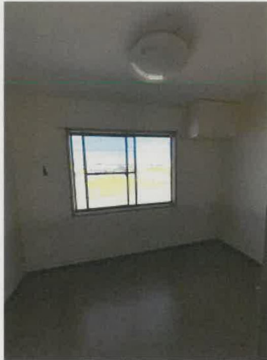
物件4 2階洋室Dの状況
