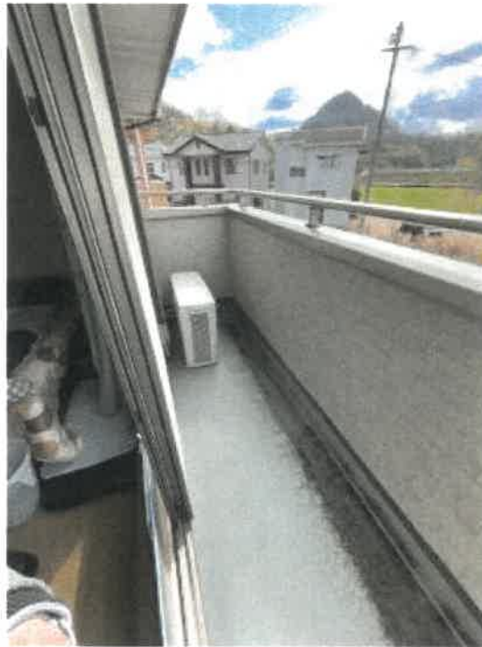
物件2 2階バルコニーの状況
