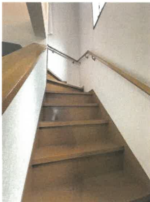
物件2 階段の状況
