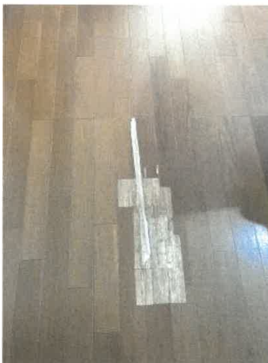
物件1 1階LD床の剥がれ状況
