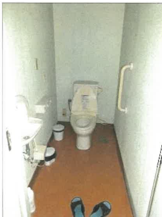
物件35建物3階の男性用浴室の脱衣所のトイレの状況
