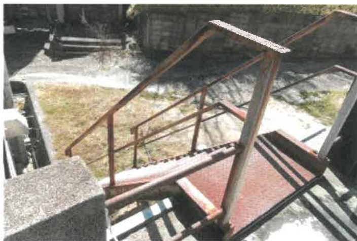
物件35建物増築部分Bの2階屋上部分から1階への外階段の状況
