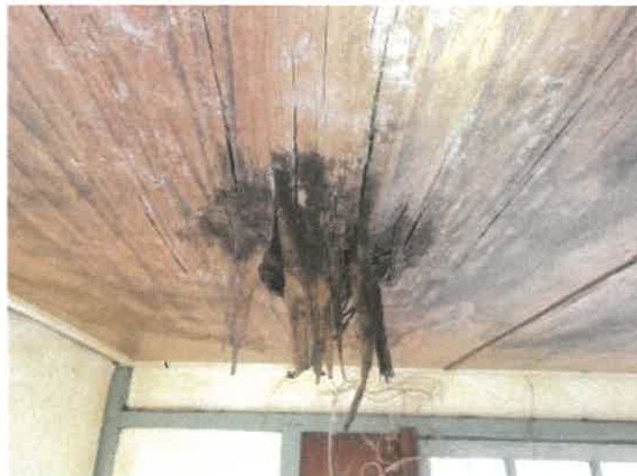
物件35未登記附属建物Cの3階天井の損傷の状況
