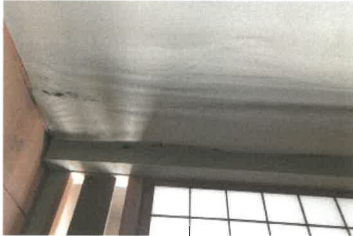
物件3 2部分3階客室⑨の天井の損傷個所の状況
