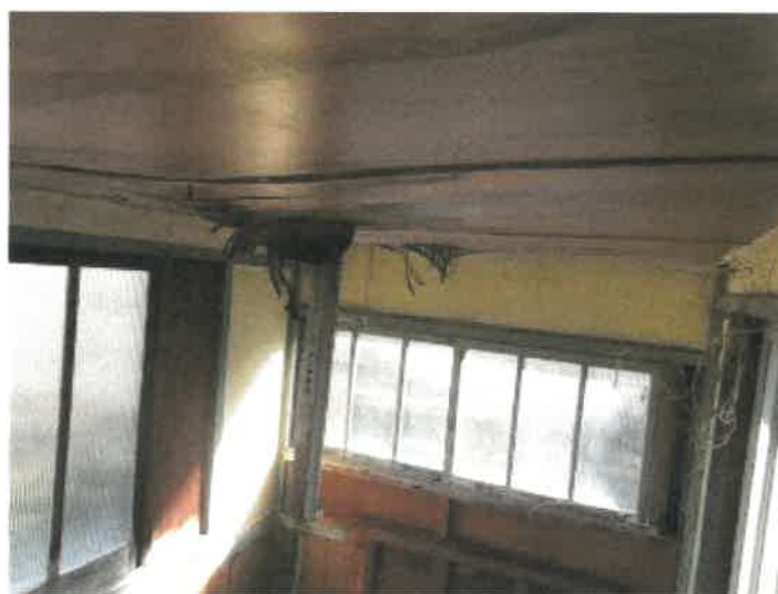
物件 3 5 未登記附属建物 C の 3 階天井の損傷の状況
