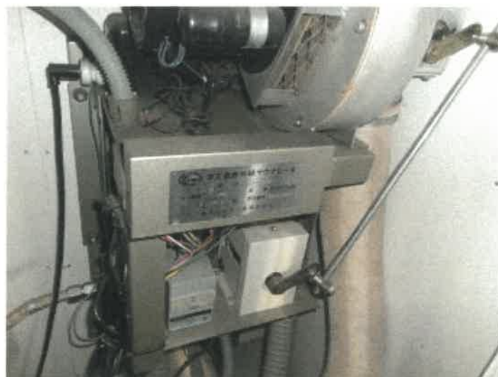
物件35建物3階の男性用浴室のサウナの機械室の状況
