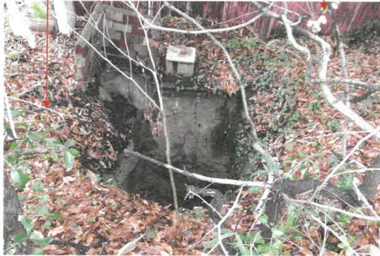
物件 3 0 主である建物西側の土地の陥没の状況
