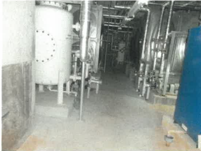
物件35建物の1階北東側機械室（ボイラー室）の状況
