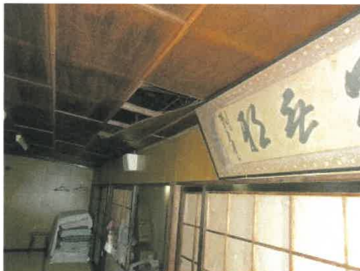
物件31部分の2階広間（宴会場）天井の損傷状況
