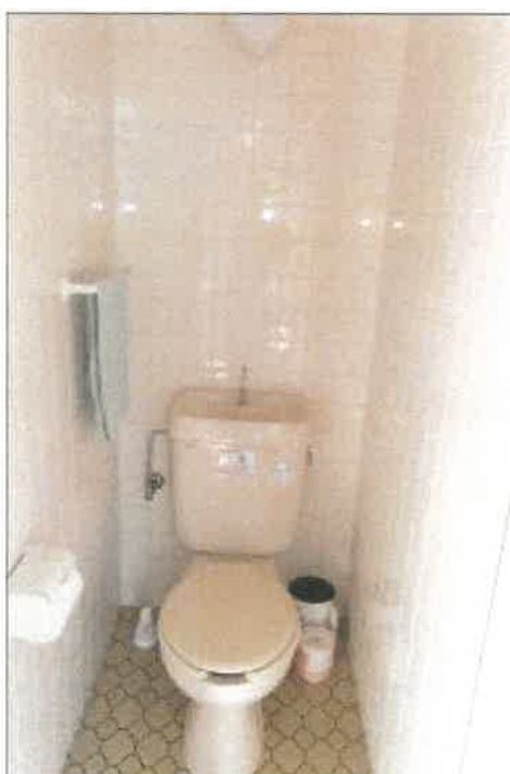
物件3 2部分3階客室⑨状況
