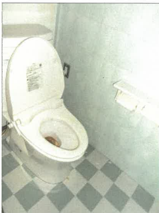
物件35建物の2階男子トイレの状況
