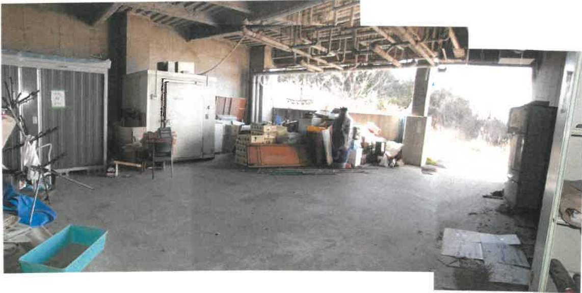
物件35建物の2階大広間の南西側厨房の更に南西側ピロティーの状況
