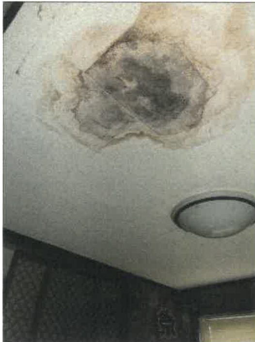
物件34建物の1階南東角洋室天井の雨漏り痕（天井の損傷）の状況
