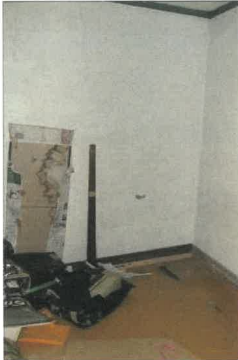
物件3 1部分の1階トイレ南東側物入内の状況
