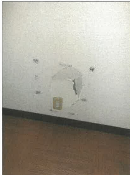
物件35建物3階の女性用脱衣場の壁の損傷状況
