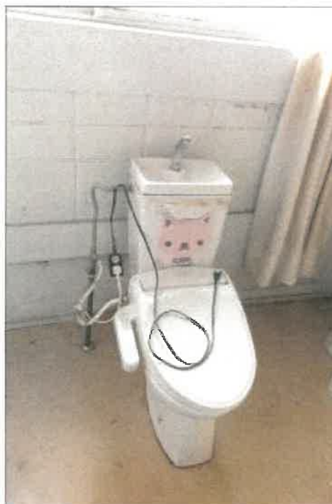
物件35建物増築部分A1階（役者用宿泊ゾーンのトイレ）の状況
