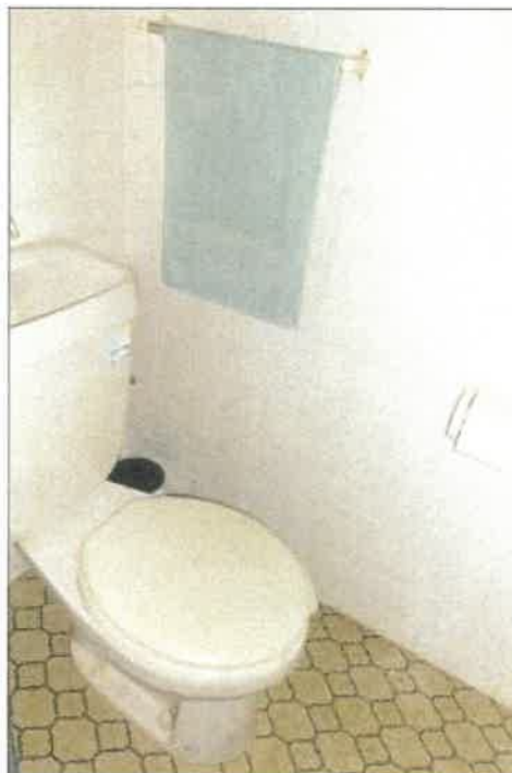
物件3 2部分3階客室⑨の状況
