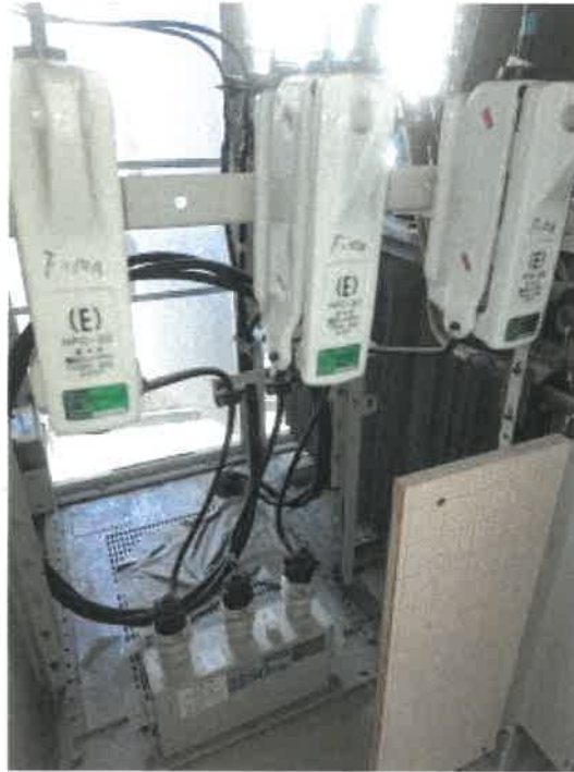
キュービクル（高圧変電設備）内の状況
