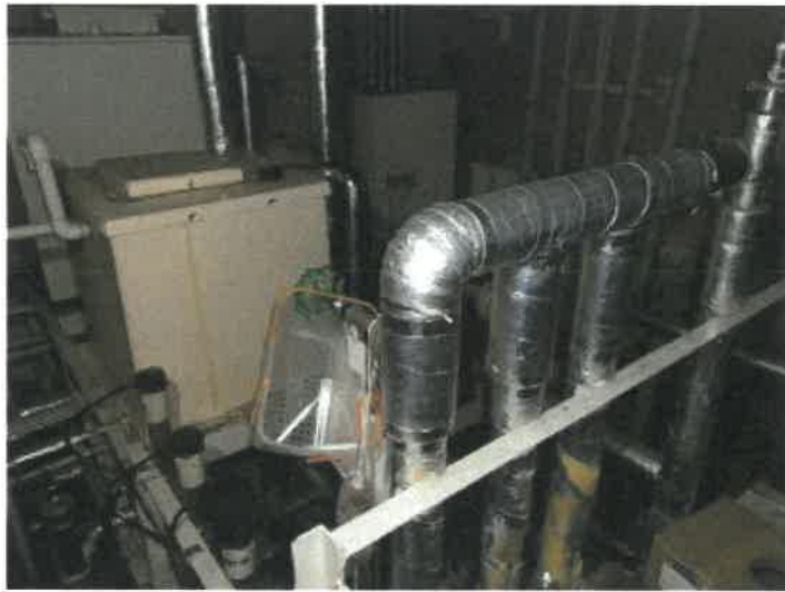
物件35建物の3階浴場のポンプ室の状況
