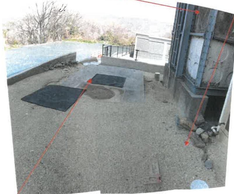
ボイラー用重油地下タンクの設置状況
