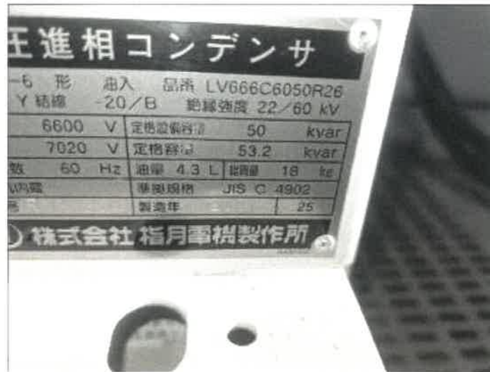
キュービクル（高圧変電設備）内の状況
