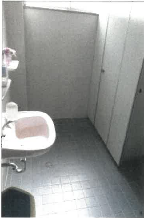
物件3 2部分1階女子トイレの状況
