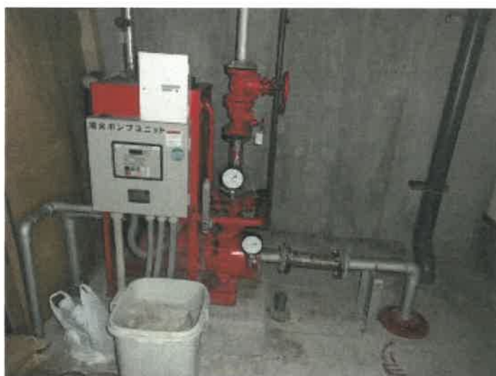
物件35建物の1階北東側機械室（ボイラー室）内の消化ポンプ室内の状況
