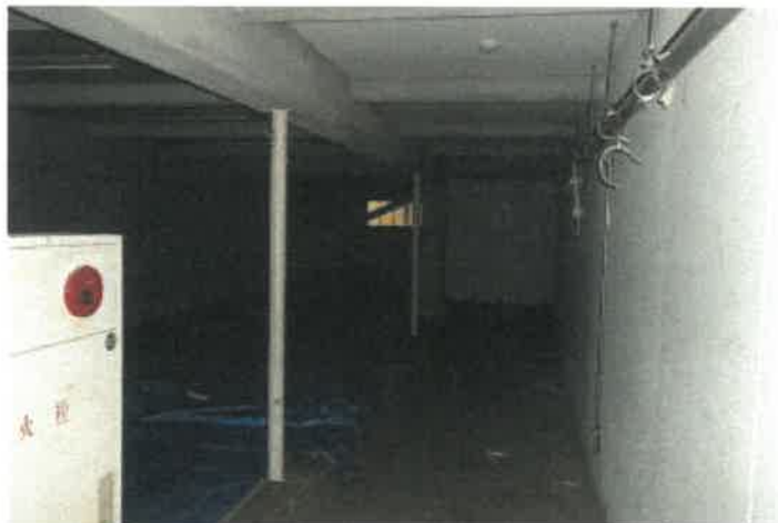
物件35建物増築部分A 1階（役者用宿泊ゾーン南西側倉庫）の状況
