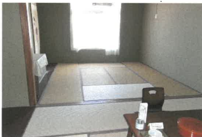
物件3 2部分3階客室⑥の状況
