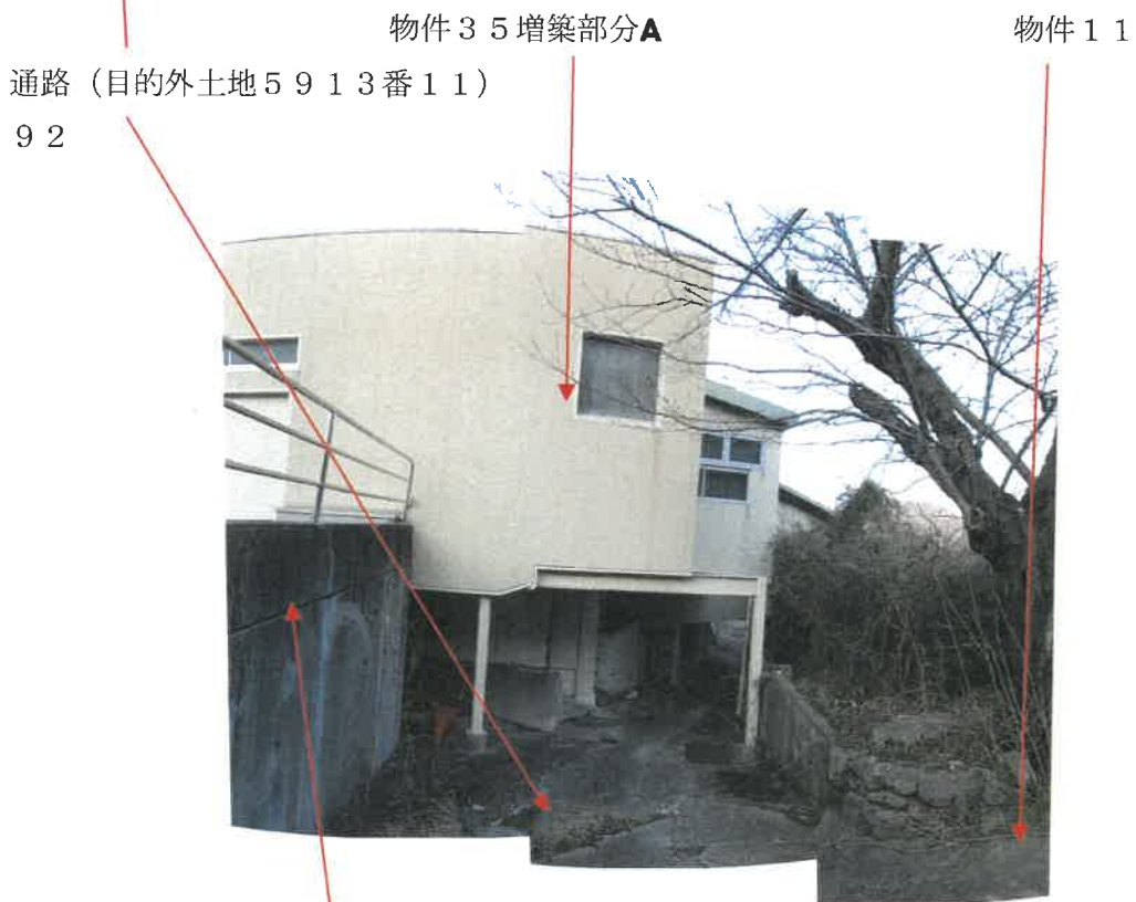
物件 3 5 増築部分 A の南東側部分の 2、3 階部分が目的外土地 5 9 1 3 番 1 1 を上空で越境している状況
