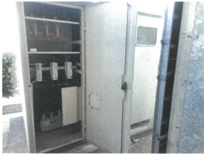
キュービクル（高圧変電設備）内の状況
