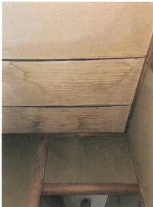
物件 2 北西側廊下天井の状況
