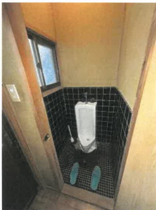
物件 2 男性用トイレの状況
