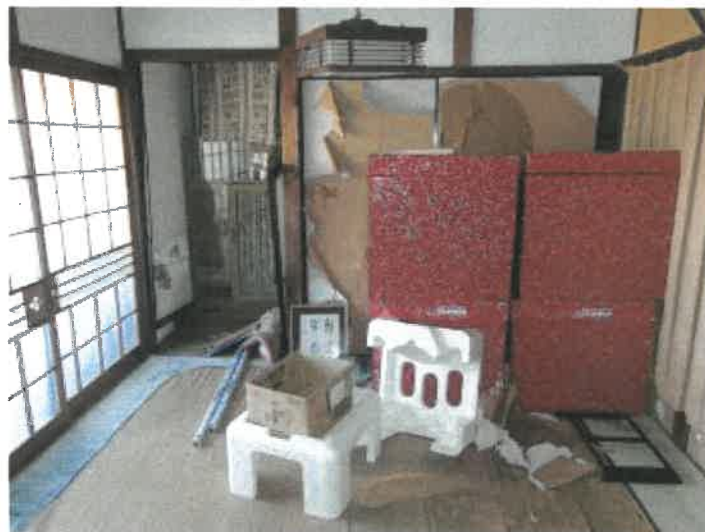
物件15建物の2階西側和室の状況
