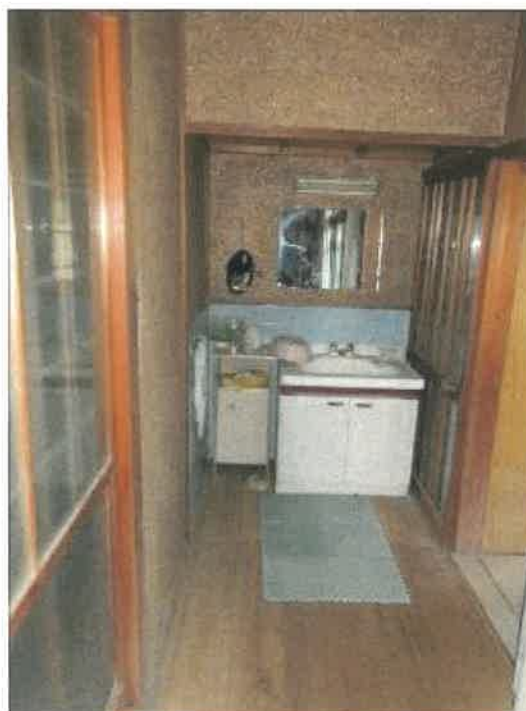
物件 1 5 建物の 1 階北ゾーンと南ゾーンの間廊下西端の手洗の状況
