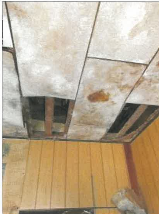
物件 1 5 建物の 1 階東側倉庫の天井の雨漏りによる損傷の状況
