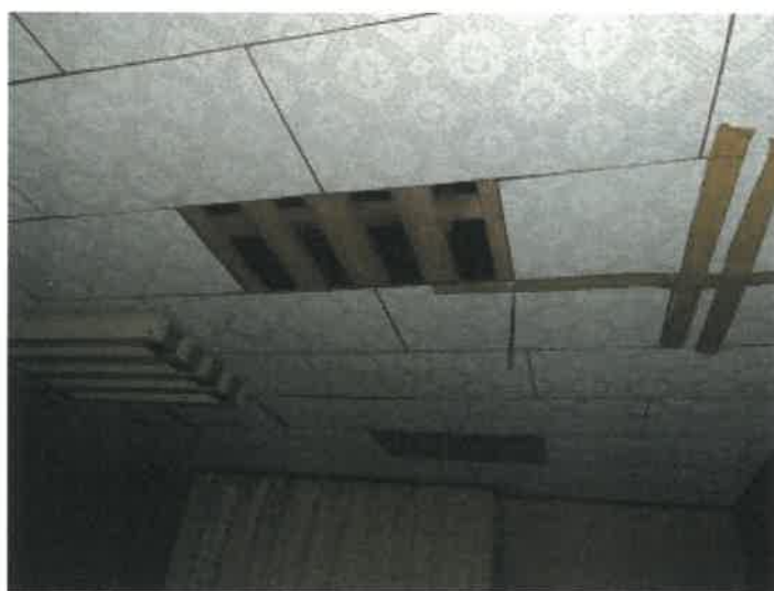
物件15建物の1階北側ゾーン西端の物置の天井の雨漏りによる損傷の状況
