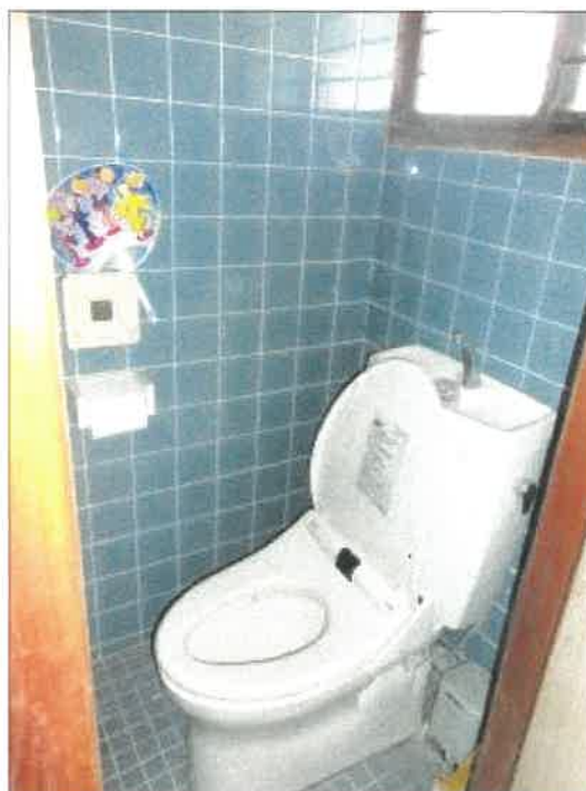
物件15建物の1階北ゾーン西端のトイレ（大）の状況
