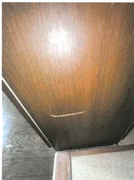
台所両面ハッチの損傷状況
