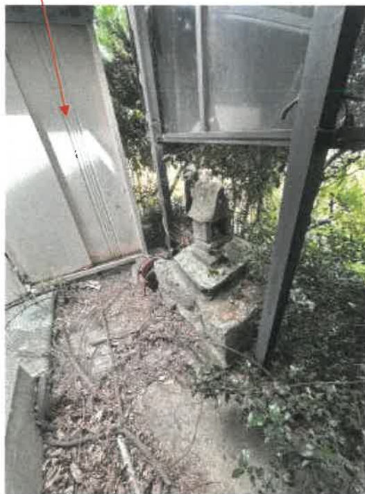
物件 1 北東角付近の祠の状況
