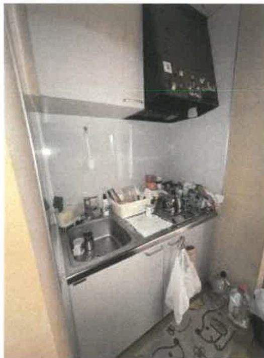
物件2 2階流し台の状況
