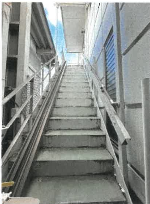
物件6 階段の状況
