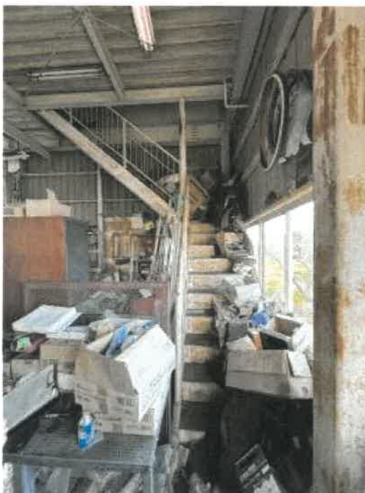
物件 5 階段の状況
