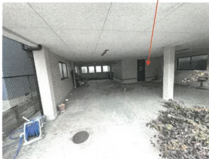
物件1 中央付近の状況
