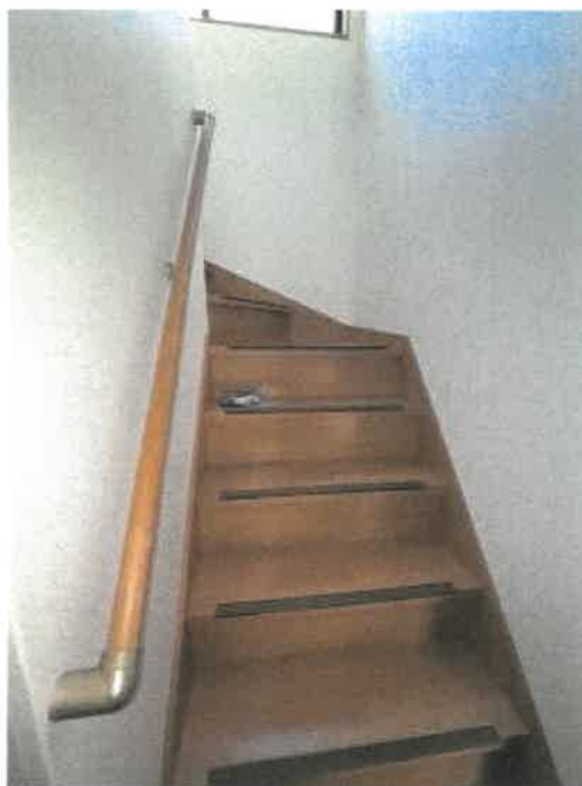
物件3 階段の状況
