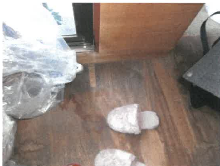
物件2建物の3階物置の雨漏りの状況
