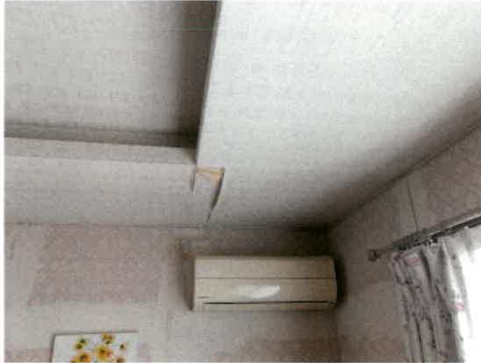
物件 2 建物の 1 階 LDK の天井南東角付近の壁紙の損傷状況
