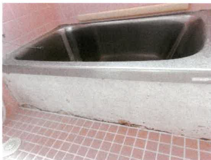
物件 2 建物の 1 階浴室の損傷状況
