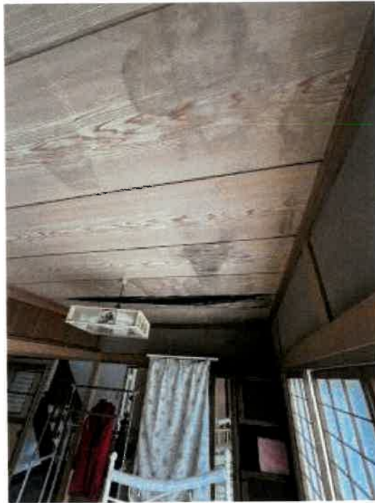
物件2 1階南西側和室天井の状況
