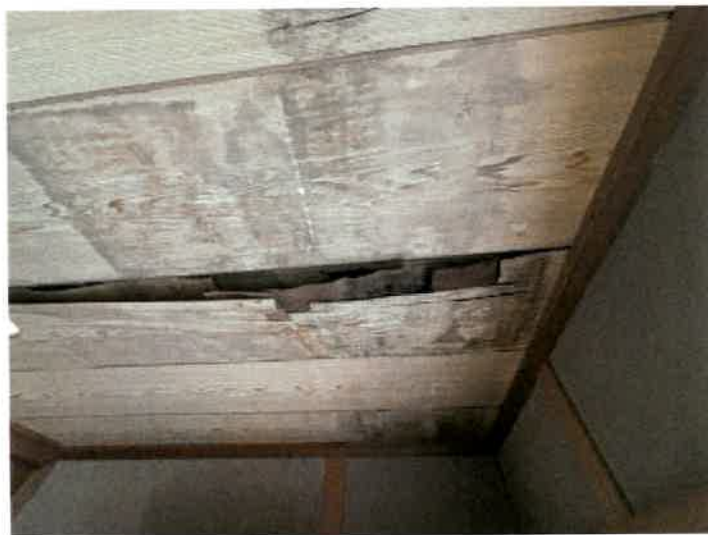
物件2 1階南西側和室天井の破損状況
