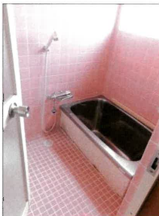
物件 2 建物の 1 階浴室の損傷状況
