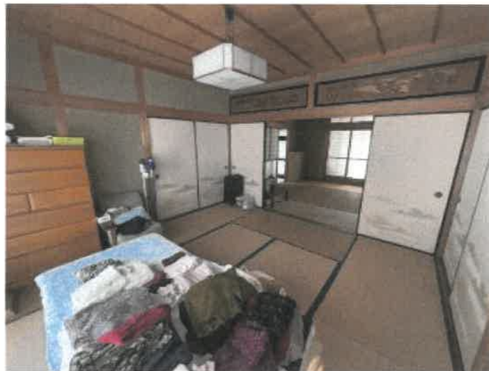
物件2 1階北西側和室の状況
