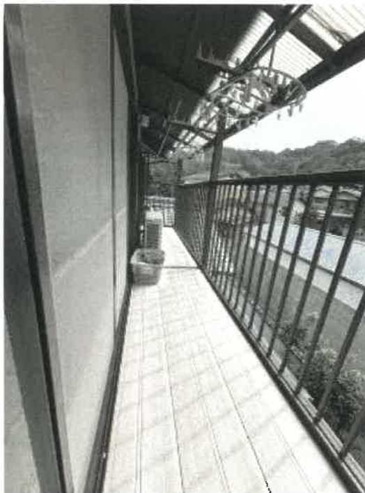
物件2 バルコニーの状況
