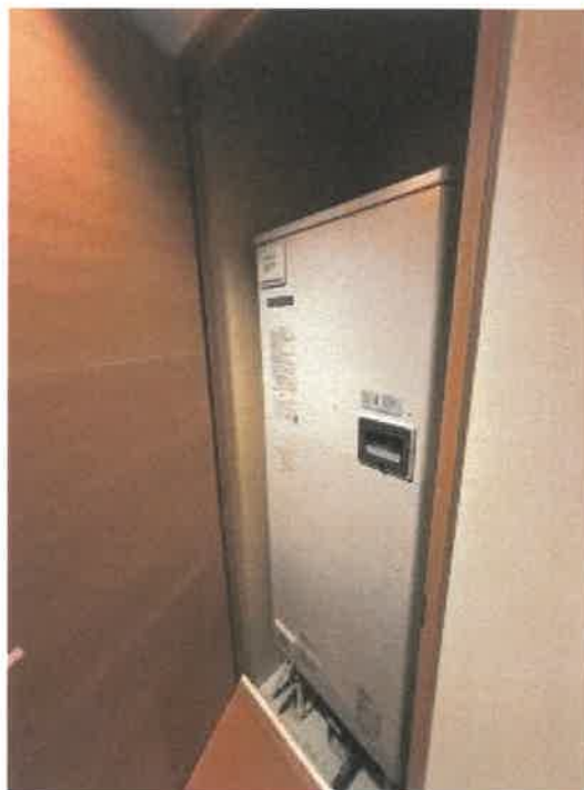
温水器の状況
