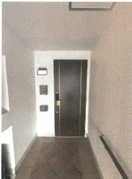
本件物件（803号室）の玄関ドアの状況
