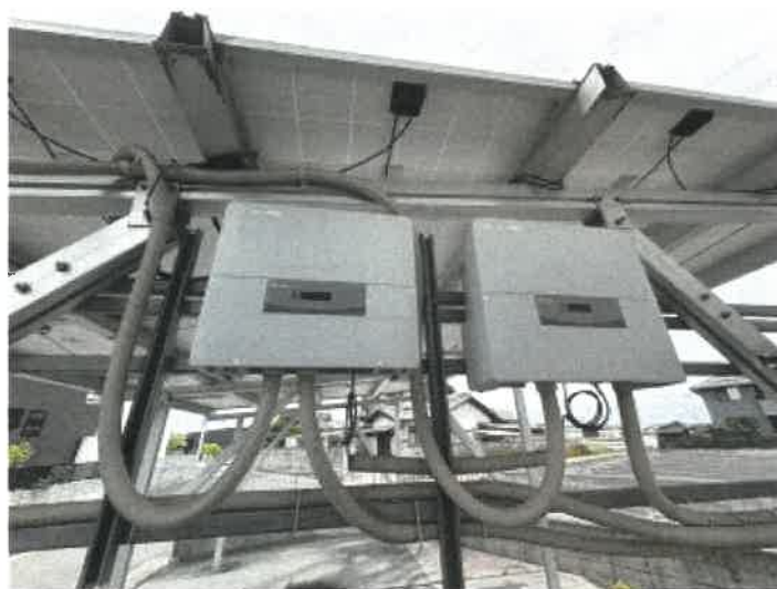
物件1 カーポート側面のパワコンの状況
