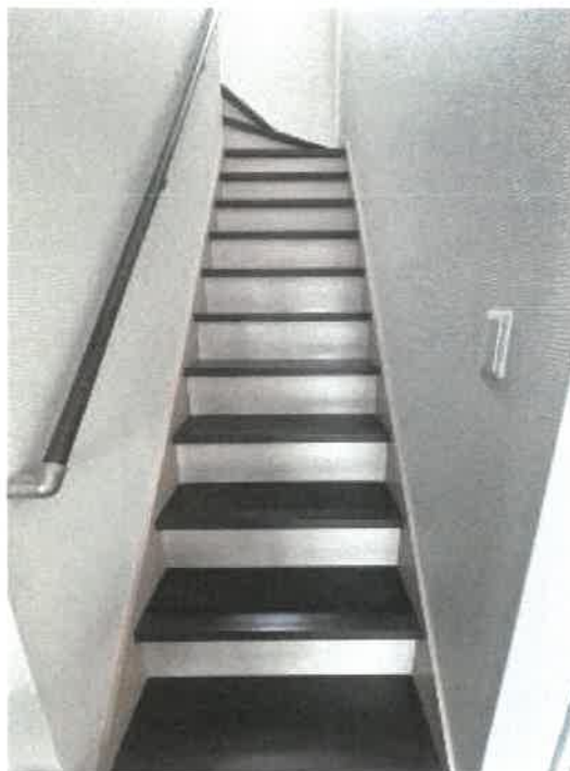
物件 2 階段の状況
