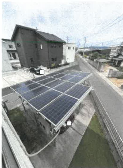
物件1 カーポート屋根の太陽光発電設備の状況
