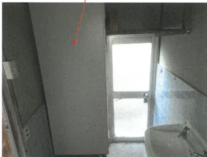
物件2建物の1階洗面脱衣所の状況
