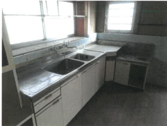
物件2建物の1階DKの状況
