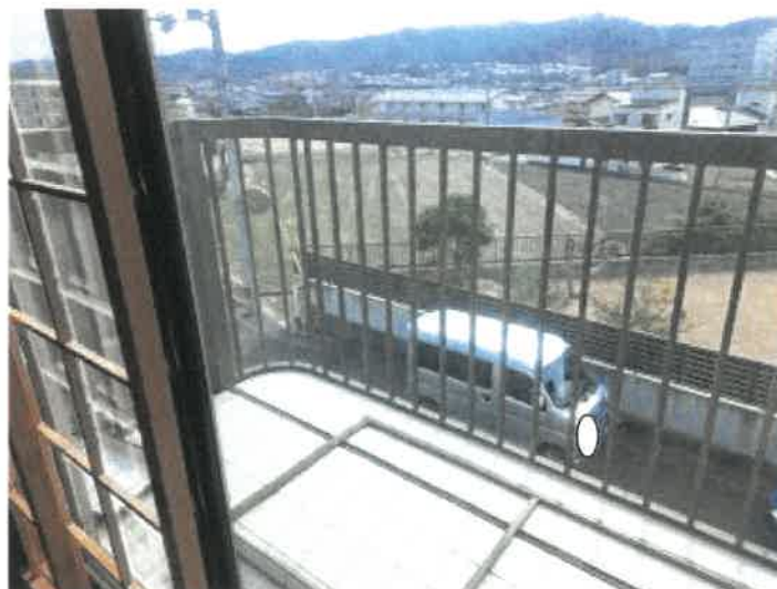
物件 2 建物の 2 階南西側バルコニーの状況
