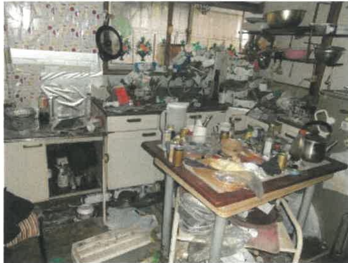
物件2建物の1階DKの状況
