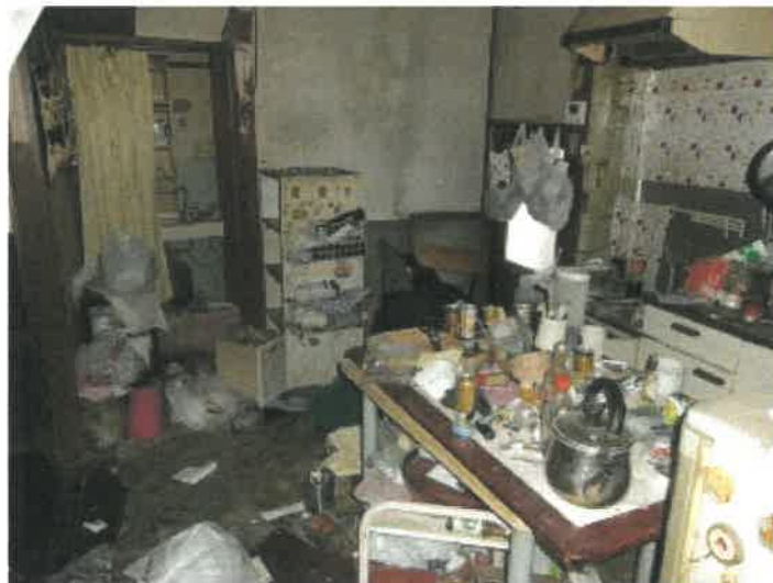
物件2建物の1階DKの状況
