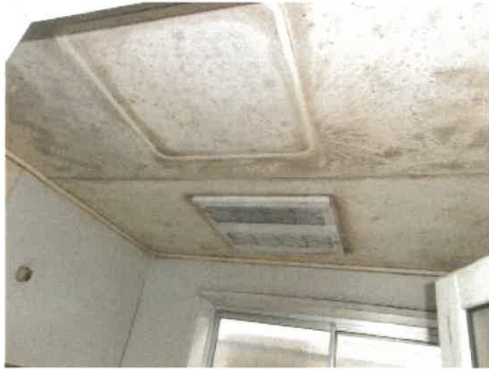
物件 2 建物の 1 階浴室天井の状況
