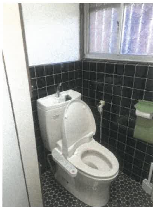
物件 2 主である建物の 1 階南ゾーンのトイレの状況
