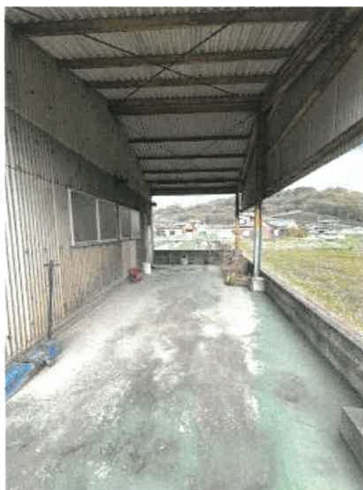
物件2 南側下屋の状況
