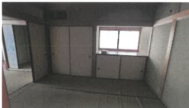
物件 1 1 主である建物 1 階西側和室の状況
