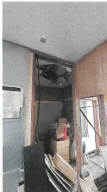
物件 1 2 主である建物天井の状況
