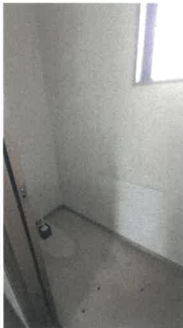
物件1 1主である建物2階便所の状況
