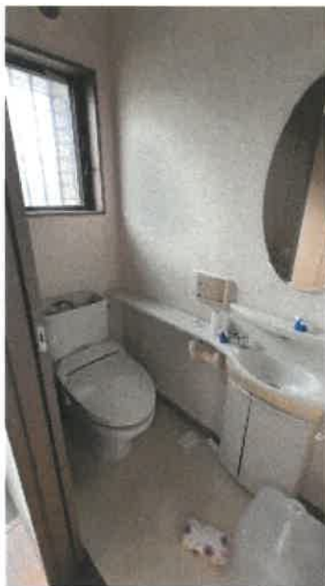
物件11主である建物1階便所の状況
