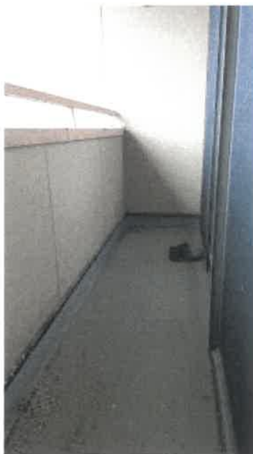
物件 1 1 主である建物 2 階ベランダの状況
