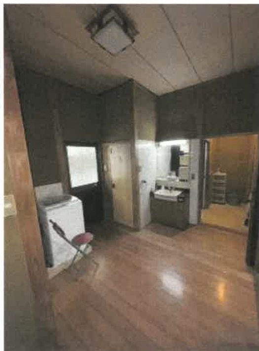
物件 2 洗面所付近の状況
