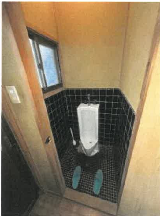
物件 2 男性用トイレの状況
