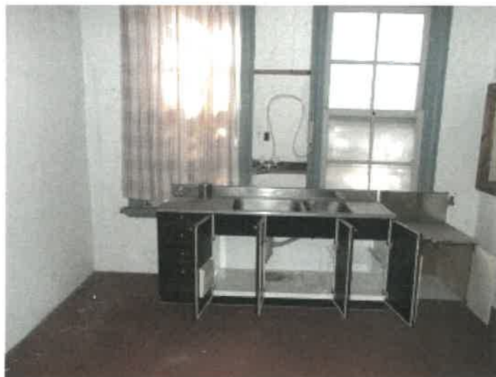
物件 3 5 未登記附属建物 C の 2 階台所の状況
