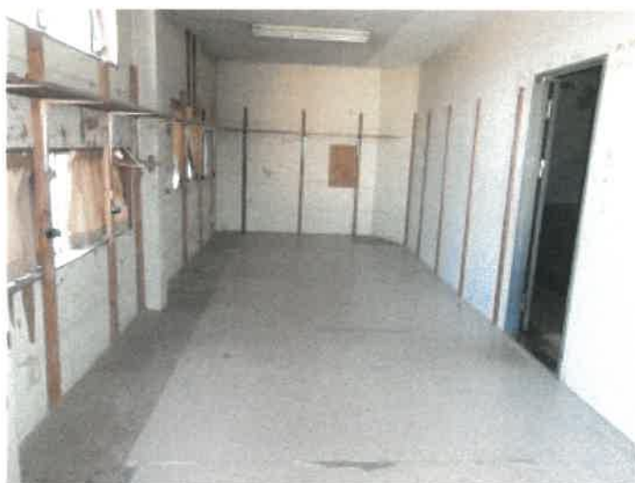
物件 3 5 建物増築部分 A 2 階（演劇場ステージの裏）の状況
