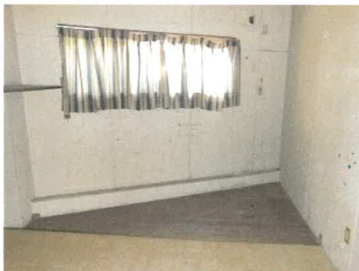
物件 3 5 建物増築部分A 2階（演劇場ステージ裏の役者控室）の状況
