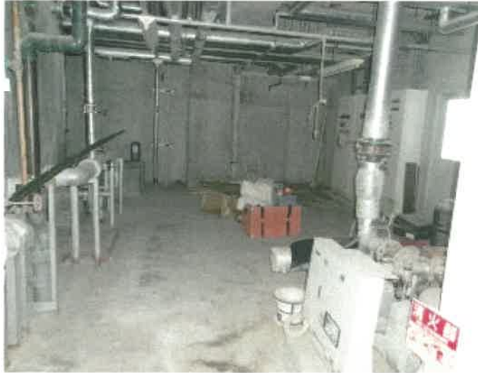
物件 3 5 建物の 1 階北東側機械室（ボイラー室）の状況
