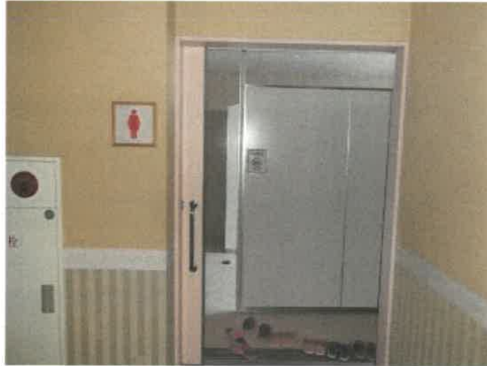
物件 3 5 建物の 2 階女子トイレの状況
