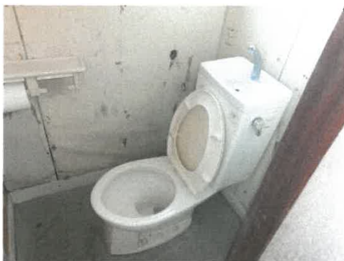
物件 3 5 建物増築部分 A 2 階（演劇場ステージ裏の役者用トイレ）の状況
