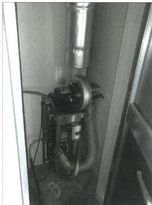
物件 3 5 建物 3 階の男性用浴室のサウナの機械室の状況
