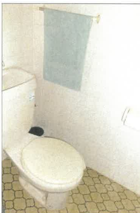
物件 3 2 部分 3 階客室⑨の状況
