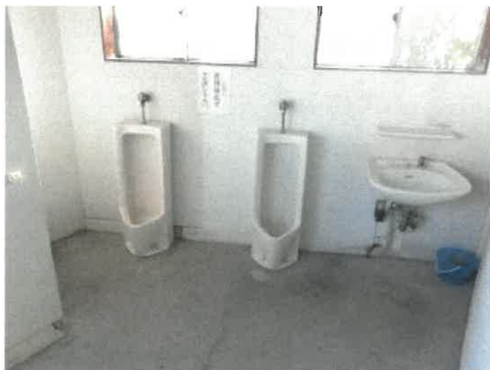
物件 3 5 建物増築部分 A 2 階（演劇場ステージ裏の役者用トイレ）の状況
