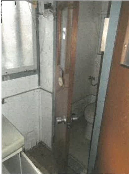
物件 3 5 未登記附属建物 C の 2 階トイレの状況
