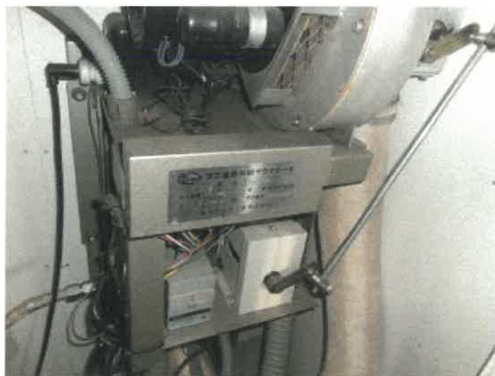
物件 3 5 建物 3 階の男性用浴室のサウナの機械室の状況
