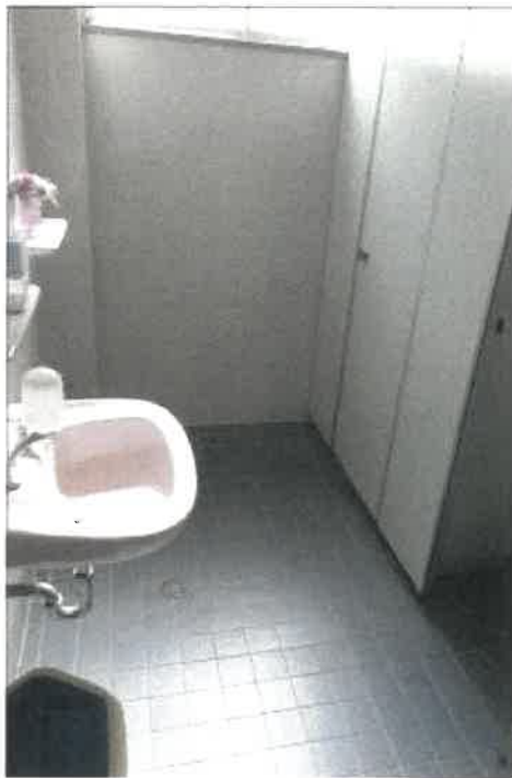
物件 3 2 部分 1 階女子トイレの状況
