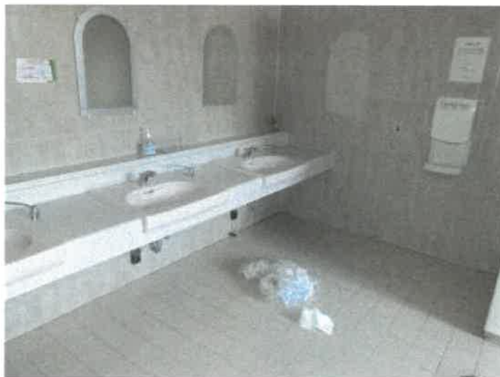
物件 3 5 建物の 2 階女子トイレの状況
