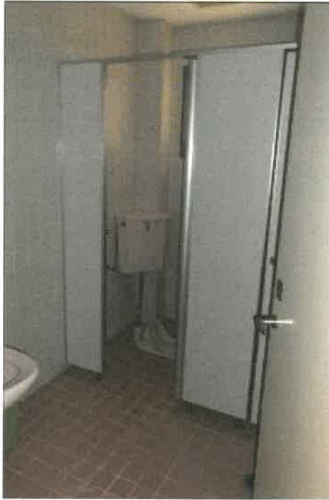
物件 3 2 部分 2 階女子トイレの状況
