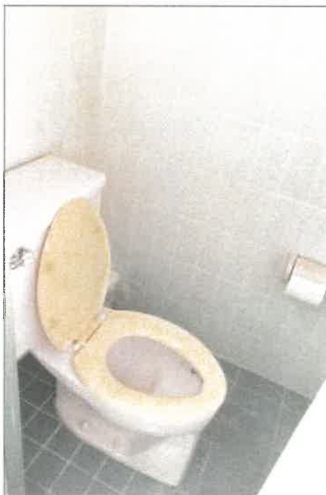
物件 3 2 部分 1 階女子トイレの状況
