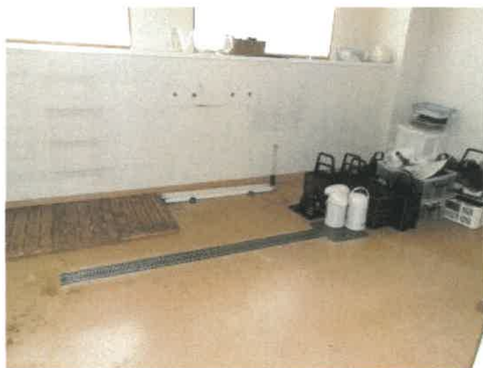
物件 3 5 建物の 2 階エレベーター昇降口奥の倉庫の状況
