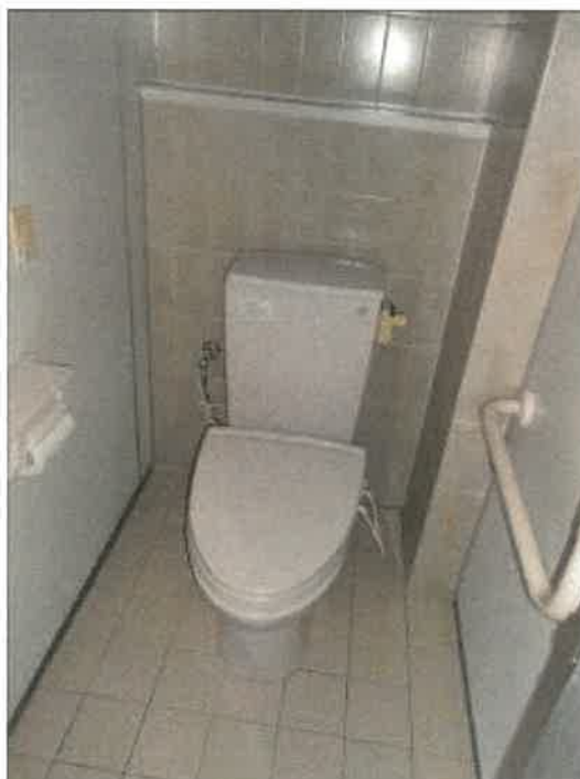
物件35建物の2階女子トイレの状況
