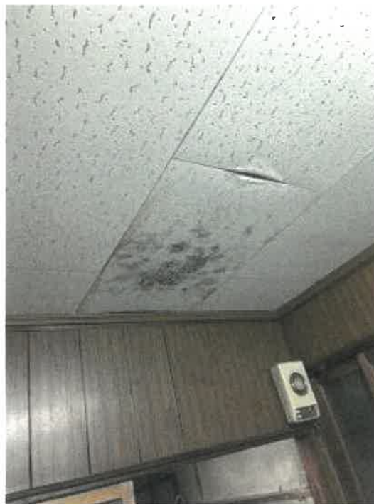
物件2 ホールの雨漏り跡の状況
