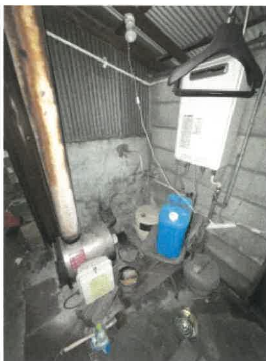
物件2 北側ホール ボイラーの状況
