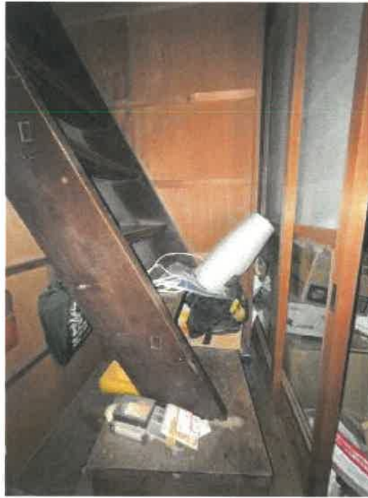
物件2 階段の状況
