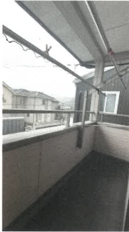
物件 2 2階ベランダの状況
